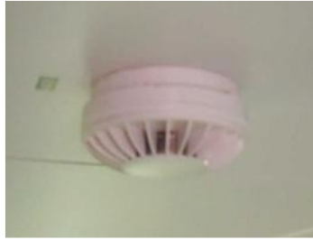
Imagen 22. Detector de humo de alta visibilidad. Fuente: Trabajo de campo.
