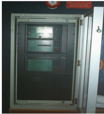
Imagen 21. Armario de Autronica del puente. Fuente: Trabajo de campo.
