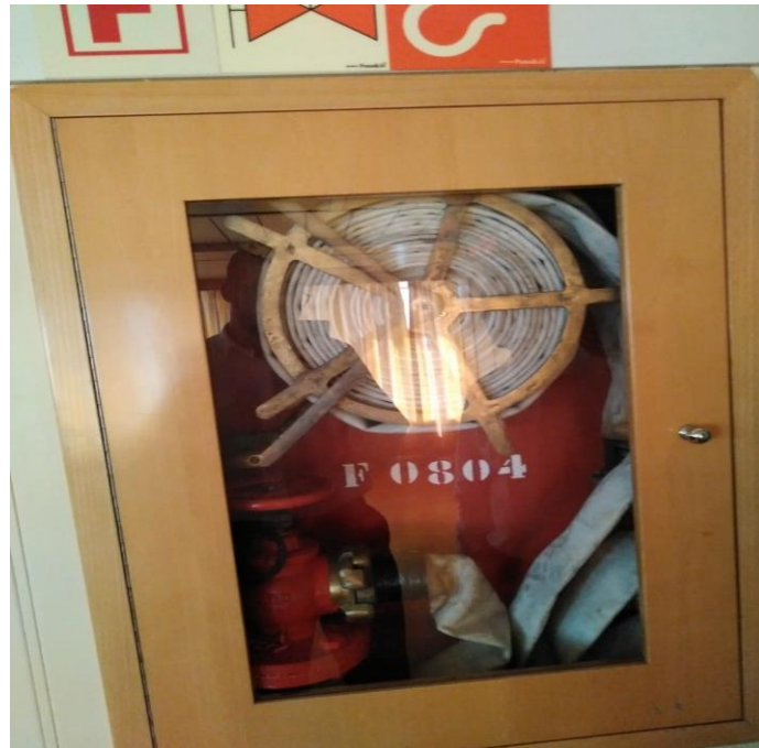
Imagen 27. Estación de Contraincendios. Fuente: Trabajo de campo.
