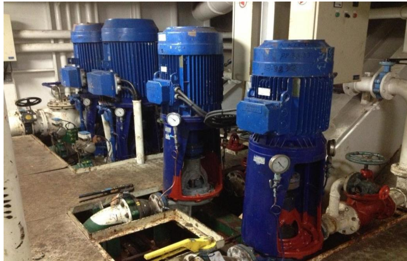
Imagen 24. Bombas del Sistema Contraincendios y Sistema Drencher.
