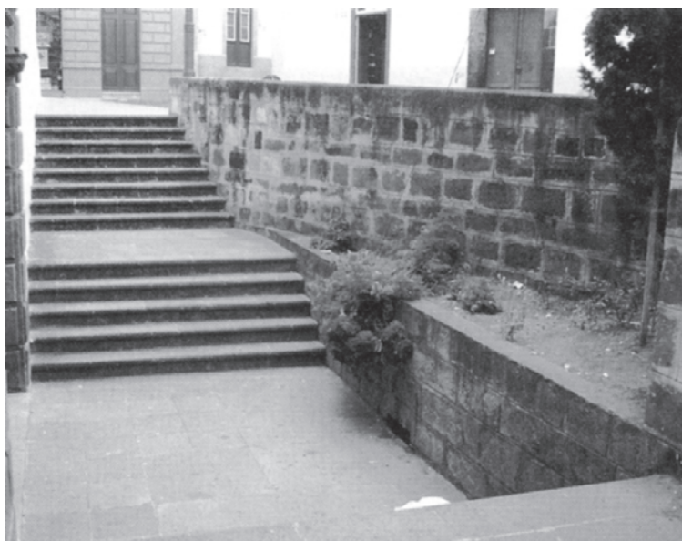
Fig. 11. Estado anterior de las escaleras traseras de acceso a El Salvador.
