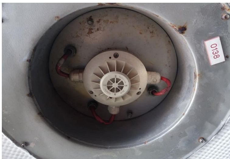
Ilustración 41: Detector de calor. Fuente: Trabajo de Campo.
