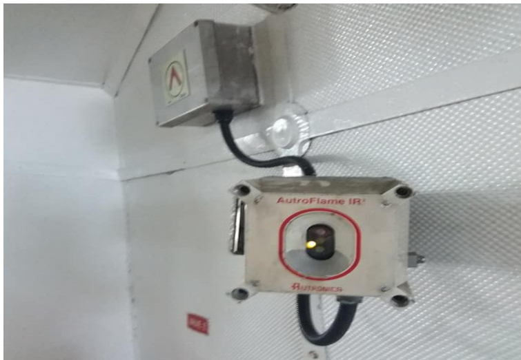
Ilustración 42: Detector de llama. Fuente: Trabajo de Campo.
