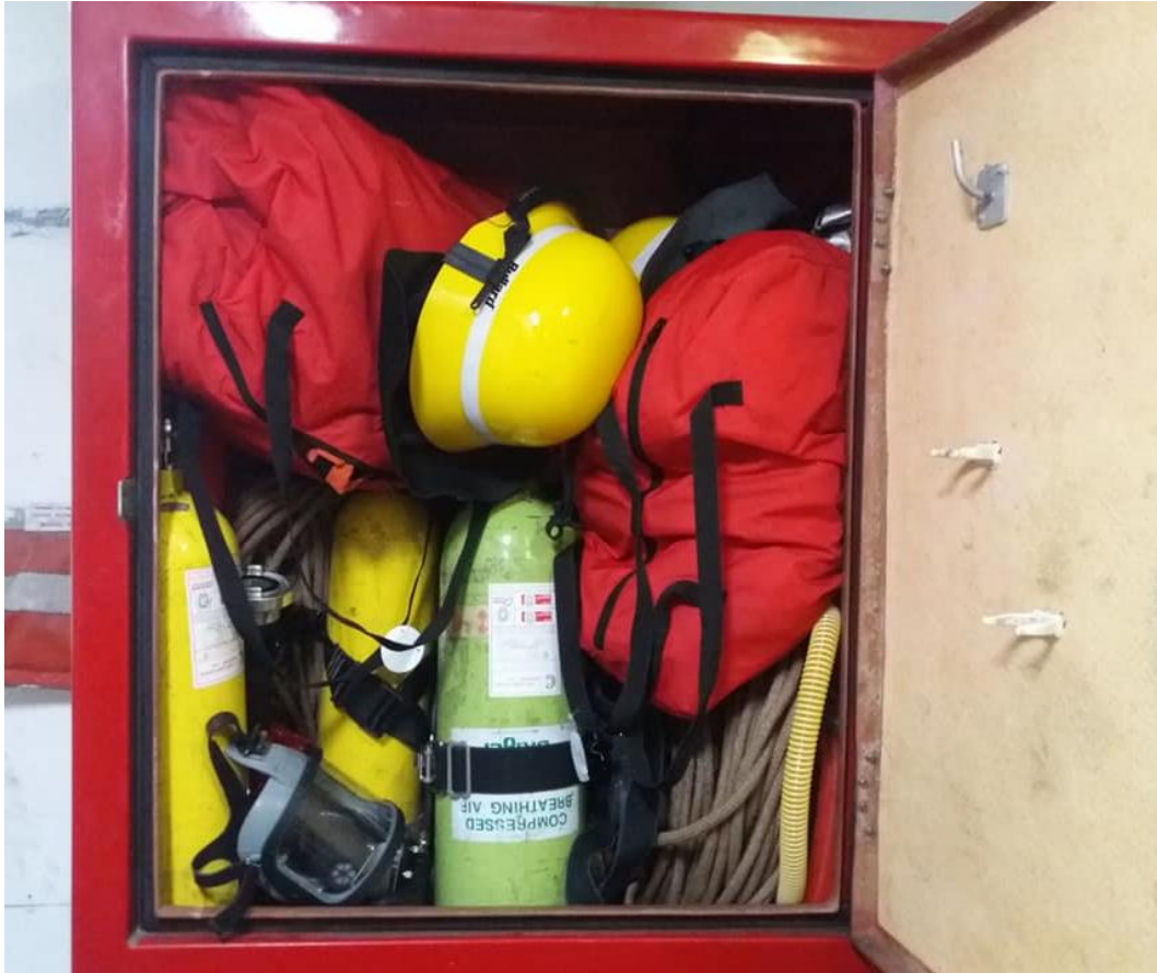
Ilustración 46: Estación contraincendios Volcán de Teno. Fuente: Trabajo de Campo.
