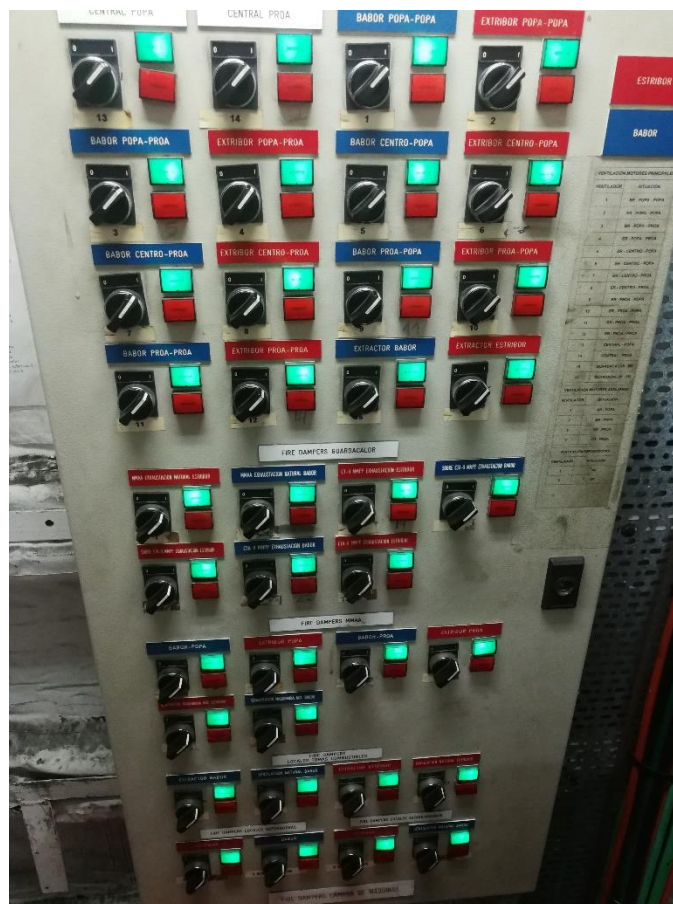
Ilustración 86. Panel de control de los fire dampers de la máquina. Fuente propia.
