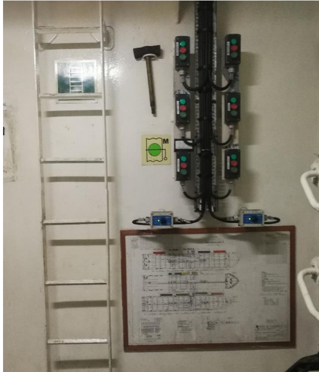
Ilustración 48. Salida de emergencia local de rociadores de garaje. Fuente propia.
