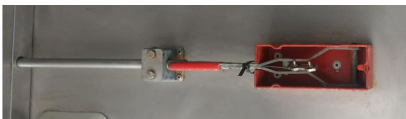
Ilustración 71. Accionamiento manual del sistema de extinción fijo de la freidora. Fuente propia.
