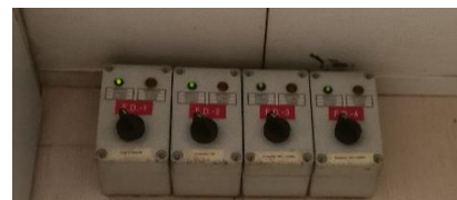
Ilustración 84. Cajas control fire dampers. Fuente propia.
