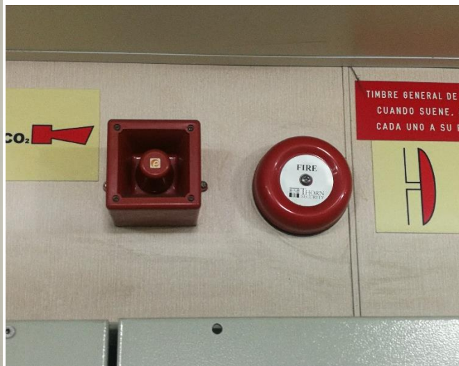
Ilustración 55. Bocina de alarma de CO 2 . Fuente propia.
