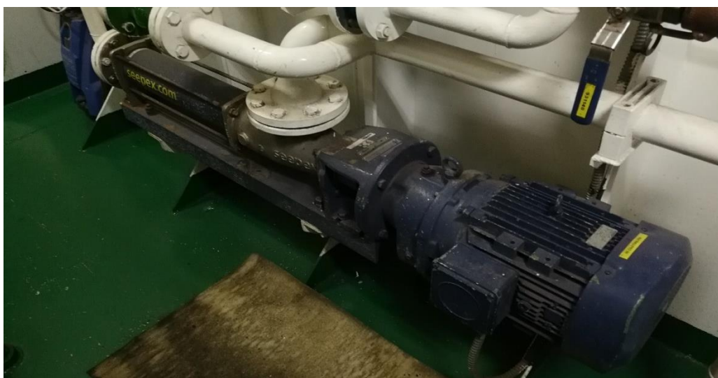
Ilustración 65. Electrobomba de los flexiFOG. Fuente propia.
