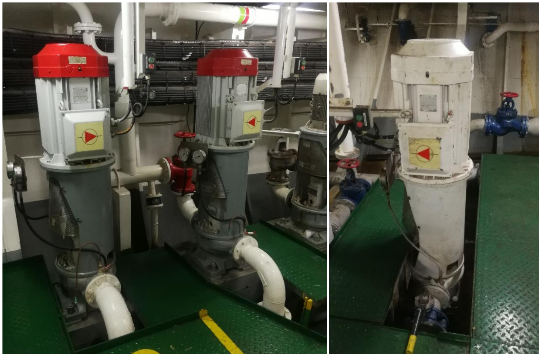
Ilustración 22. Bombas contra incendios. Fuente propia.
