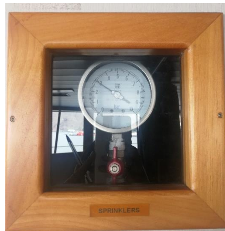
Ilustración 40. Manómetro sprinkler puente de gobierno. Fuente propia.
