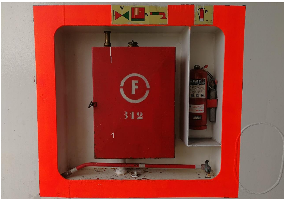
Ilustración 21. Caja contra incendio con nebulizador de agua. Fuente propia.
