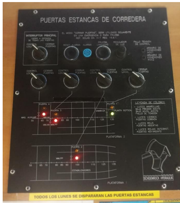
Ilustración 94. Panel puertas estancas de corredera de la máquina. Fuente propia.
