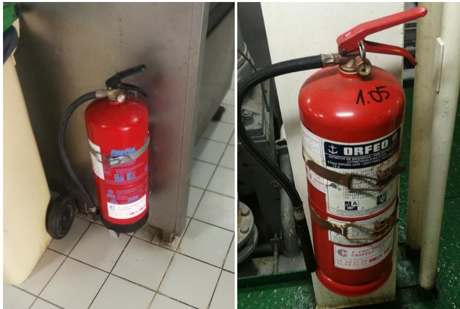
Ilustración 28. Extintores portátiles de espuma. Fuente propia.
