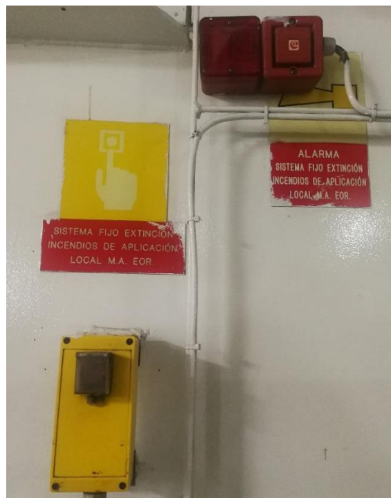
Ilustración 67. Pulsador local del sistema fijo de extinción. Fuente propia.
