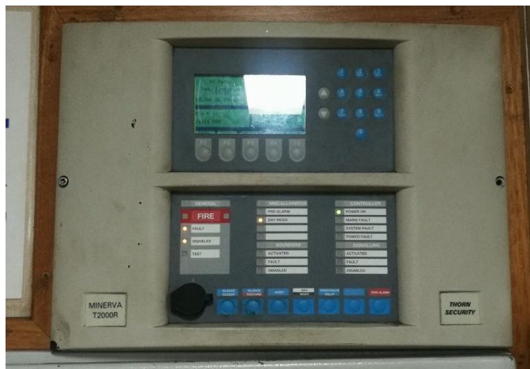
Ilustración 13. Repetidor central contra incendios, control de máquinas. Fuente propia.
