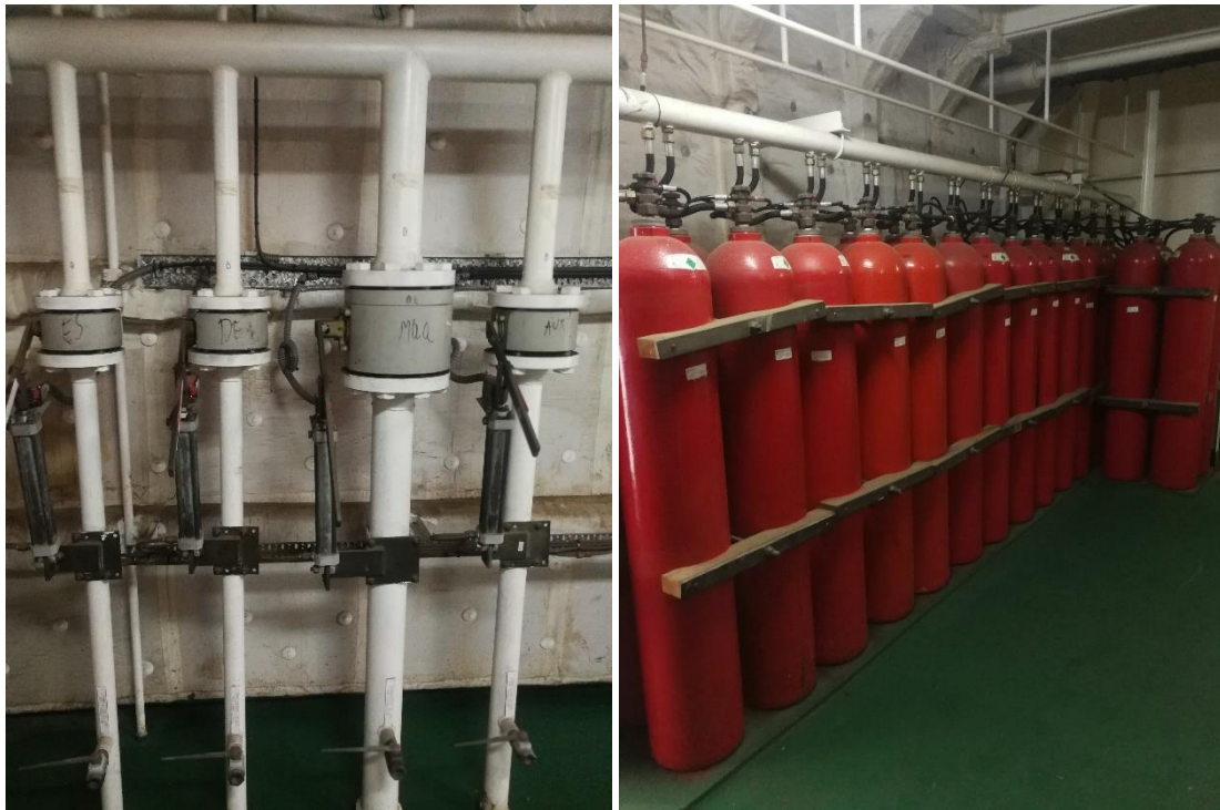
Ilustración 58. Palancas manuales disparo del CO 2 . Fuente propia.
