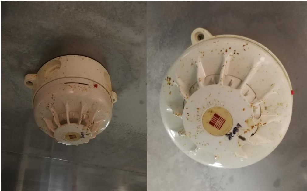
Ilustración 7. Detector de temperatura. Fuente propia.
