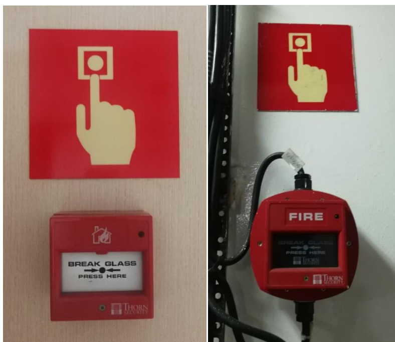
Ilustración 11. Pulsadores de incendio manuales. Fuente propia.
