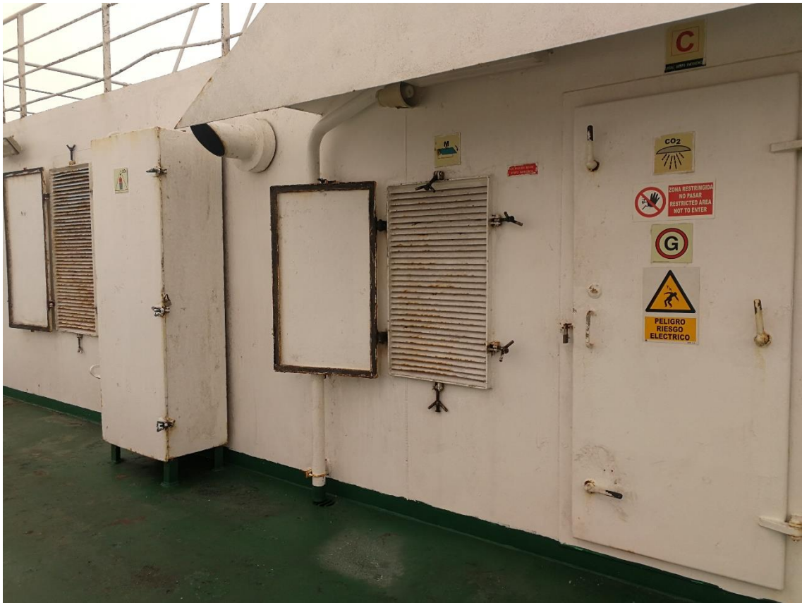
Ilustración 87. Grupo de emergencia. Fuente propia.
