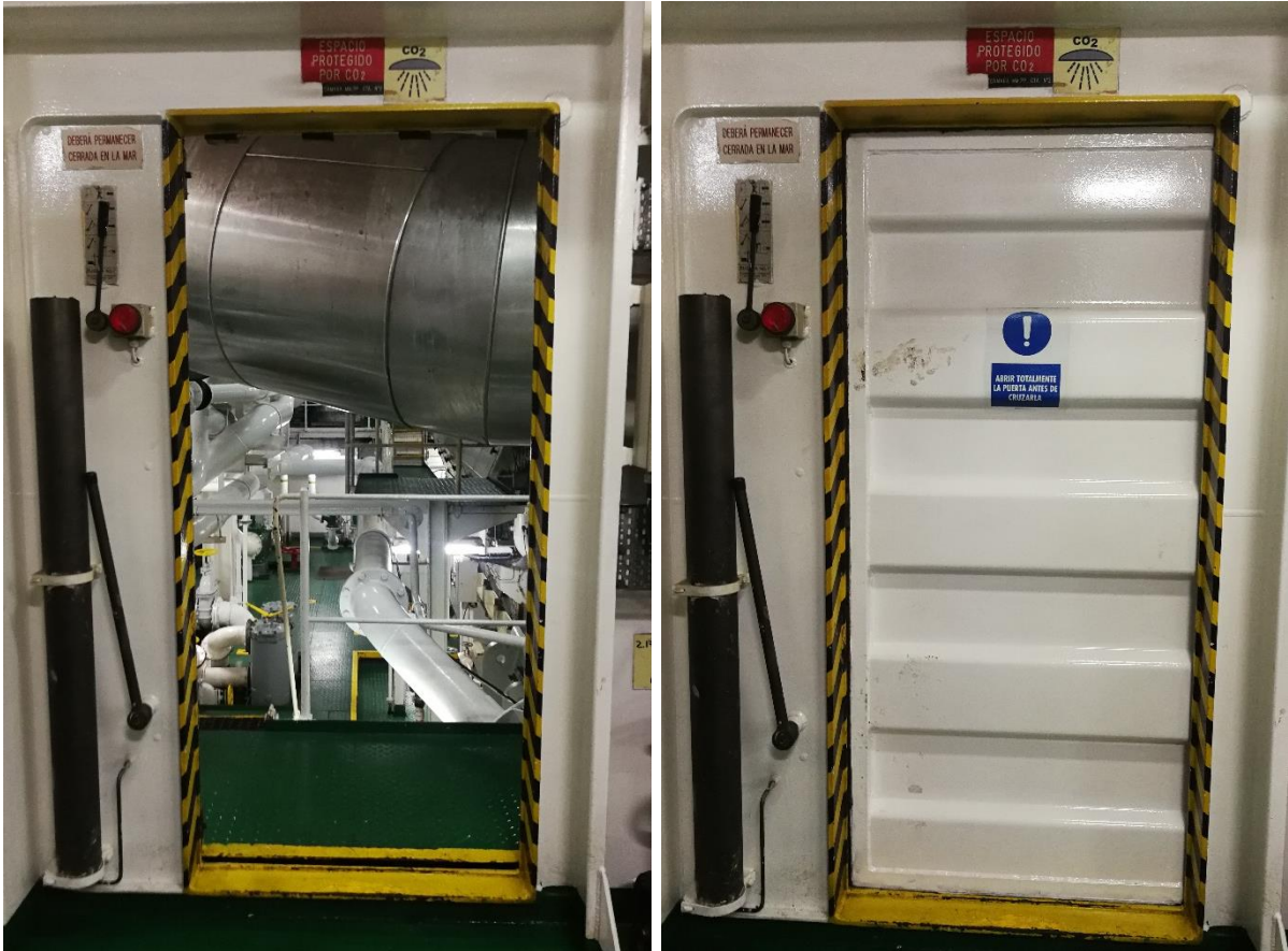
Ilustración 93. Puertas estancas correderas de la máquina. Fuente propia.
