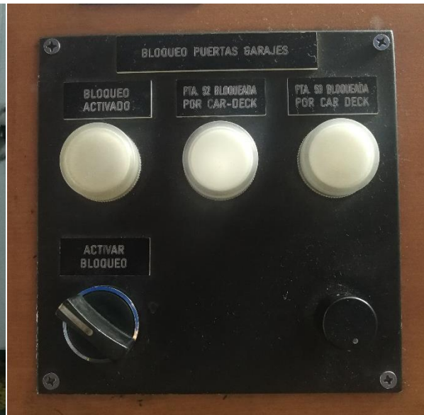
Ilustración 91. Panel de bloqueo de las puertas contra incendio de las bodegas. Fuente propia.
