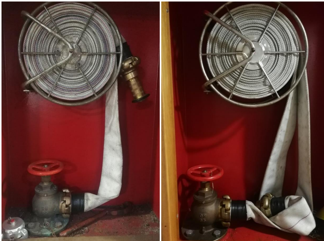
Ilustración 17. Cajas contra incendio interiores. Fuente propia.
