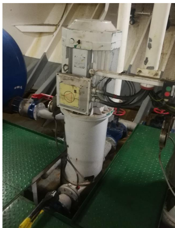
Ilustración 39. Bomba de sprinkler. Fuente propia.
