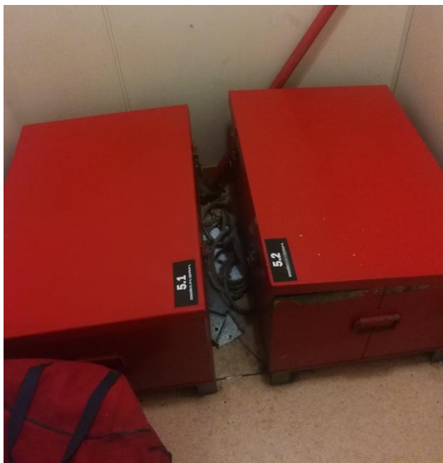
Ilustración 29. Cajas estación contra incendios. Fuente propia.
