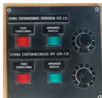
Ilustración 23. Panel control bombas contra incendios, puente de gobierno. Fuente propia.
