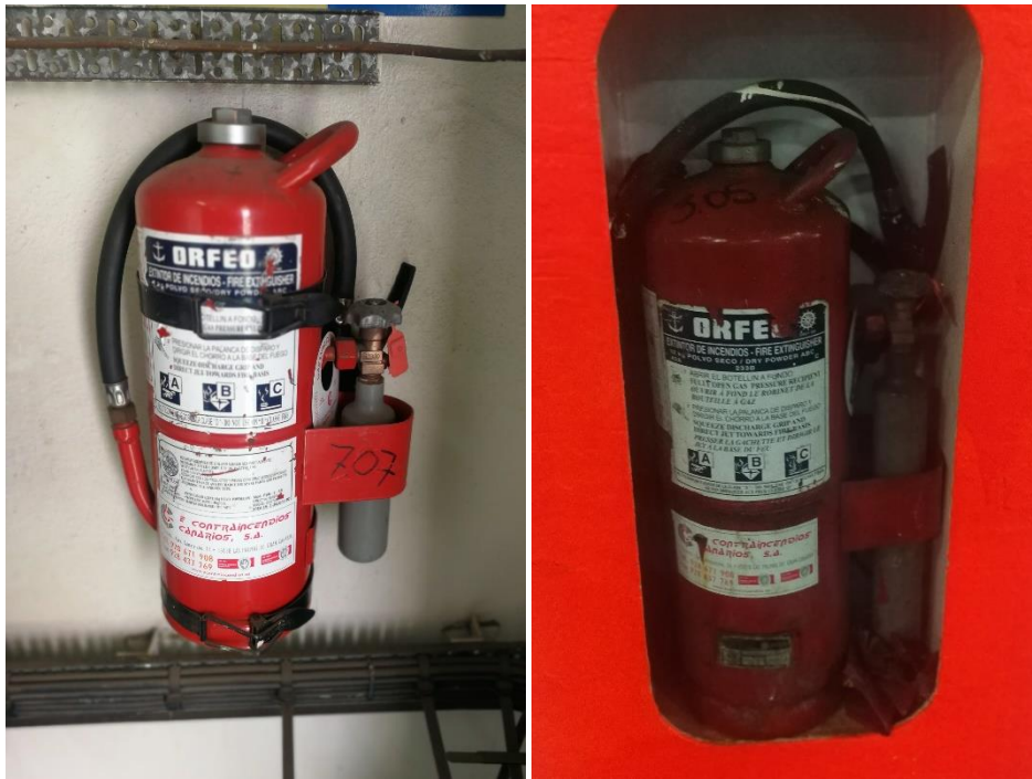
Ilustración 26. Extintores portátiles de polvo seco. Fuente propia.
