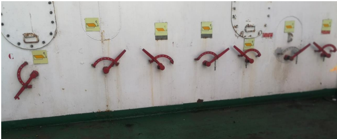
Ilustración 85. Cierres manuales de las ventilaciones de la zona de carga. Fuente propia.
