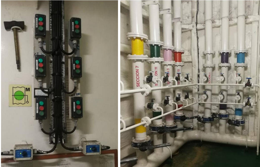
Ilustración 46. Local de rociadores de garaje. Fuente propia.
