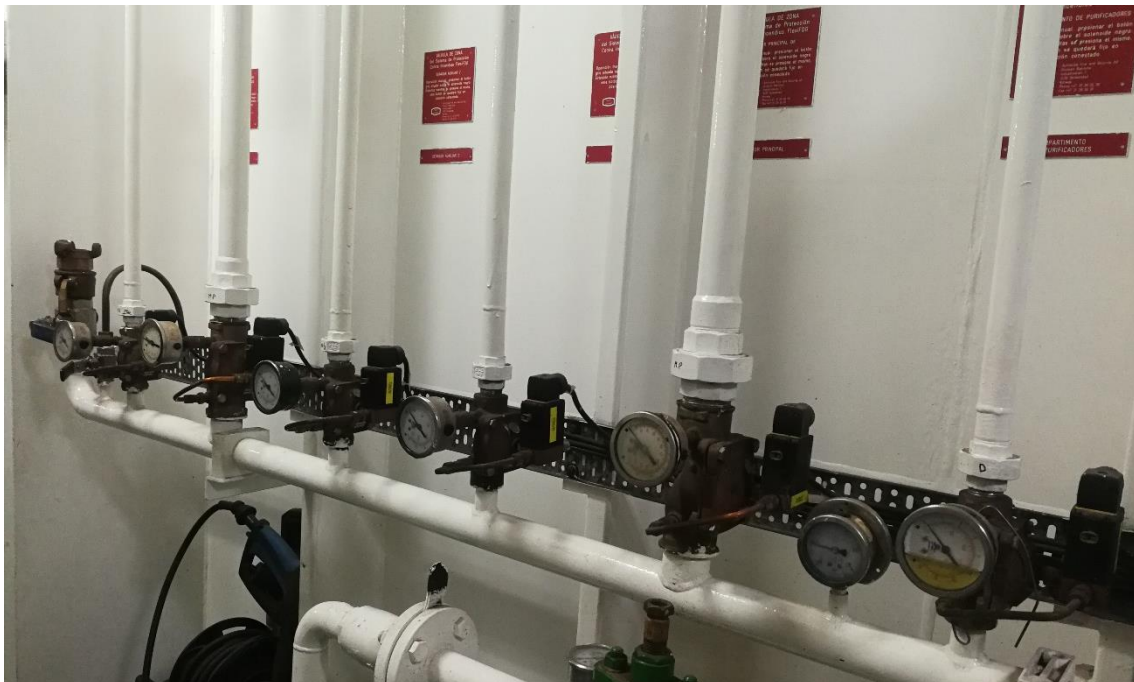
Ilustración 69. Válvulas de control de los watermist. Fuente propia.
