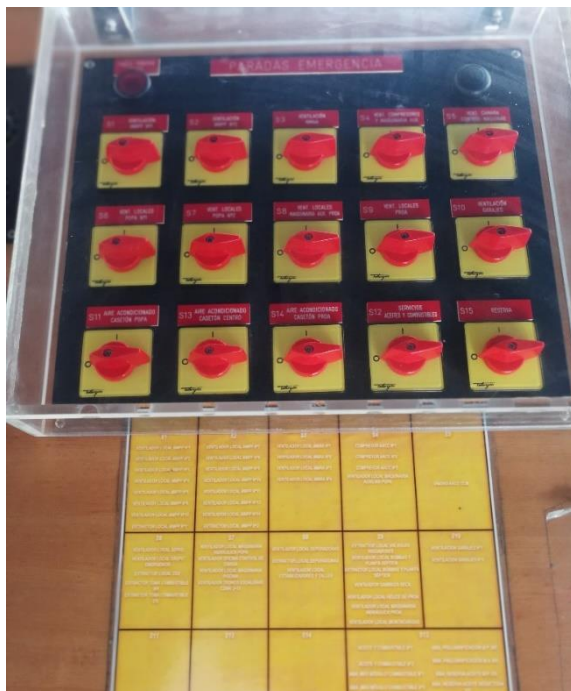
Ilustración 81. Panel de parada de emergencia de la ventilación de la máquina en el puente de gobierno. Fuente propia.
