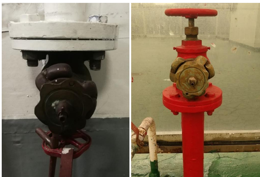
Ilustración 15. Hidrantes DN 50 y DN 65. Fuente propia.
