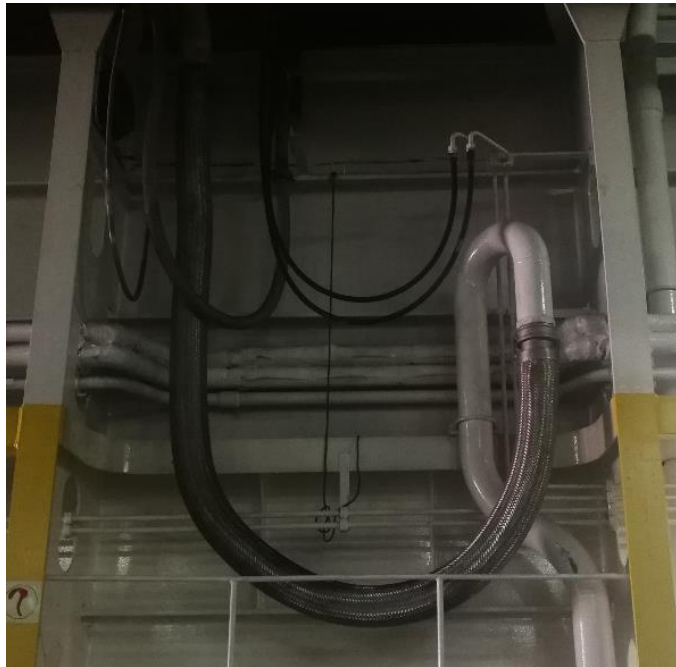
Ilustración 51. Tubería flexible de garaje. Fuente propia.
