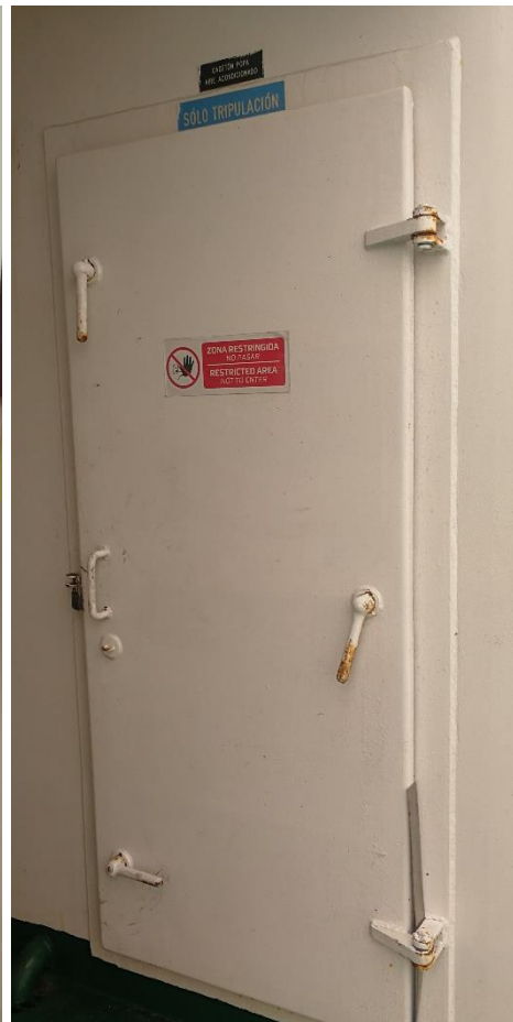
Ilustración 78. Casetón del aire acondicionado. Fuente propia.
