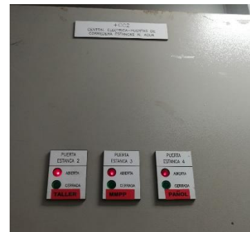
Ilustración 96. Panel luminoso para saber estado de las puertas estancas de la máquina. Fuente propia.
