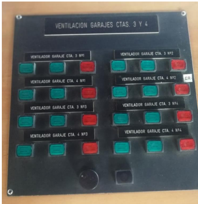
Ilustración 79. Panel de control de la zona de carga en el puente de gobierno. Fuente propia.
