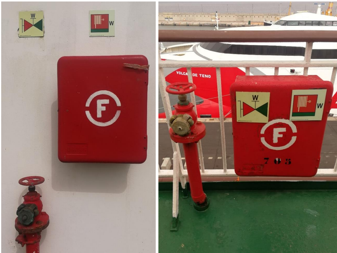
Ilustración 16. Cajas contra incendios exteriores. Fuente propia.
