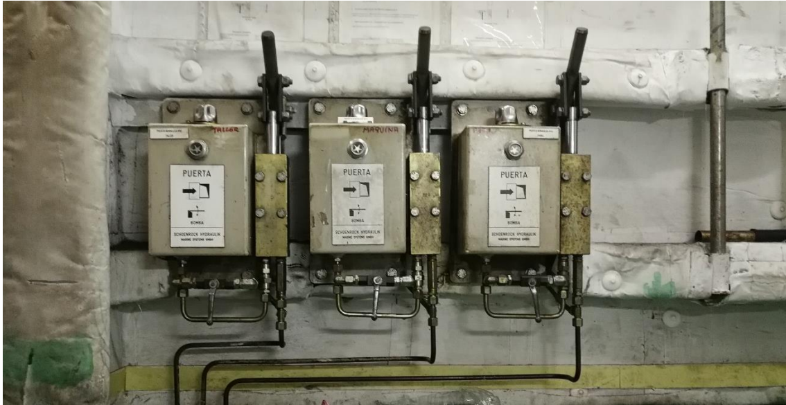
Ilustración 95. Bombas manuales para el cierre de las puertas estancas de la máquina en emergencia. Fuente propia.
