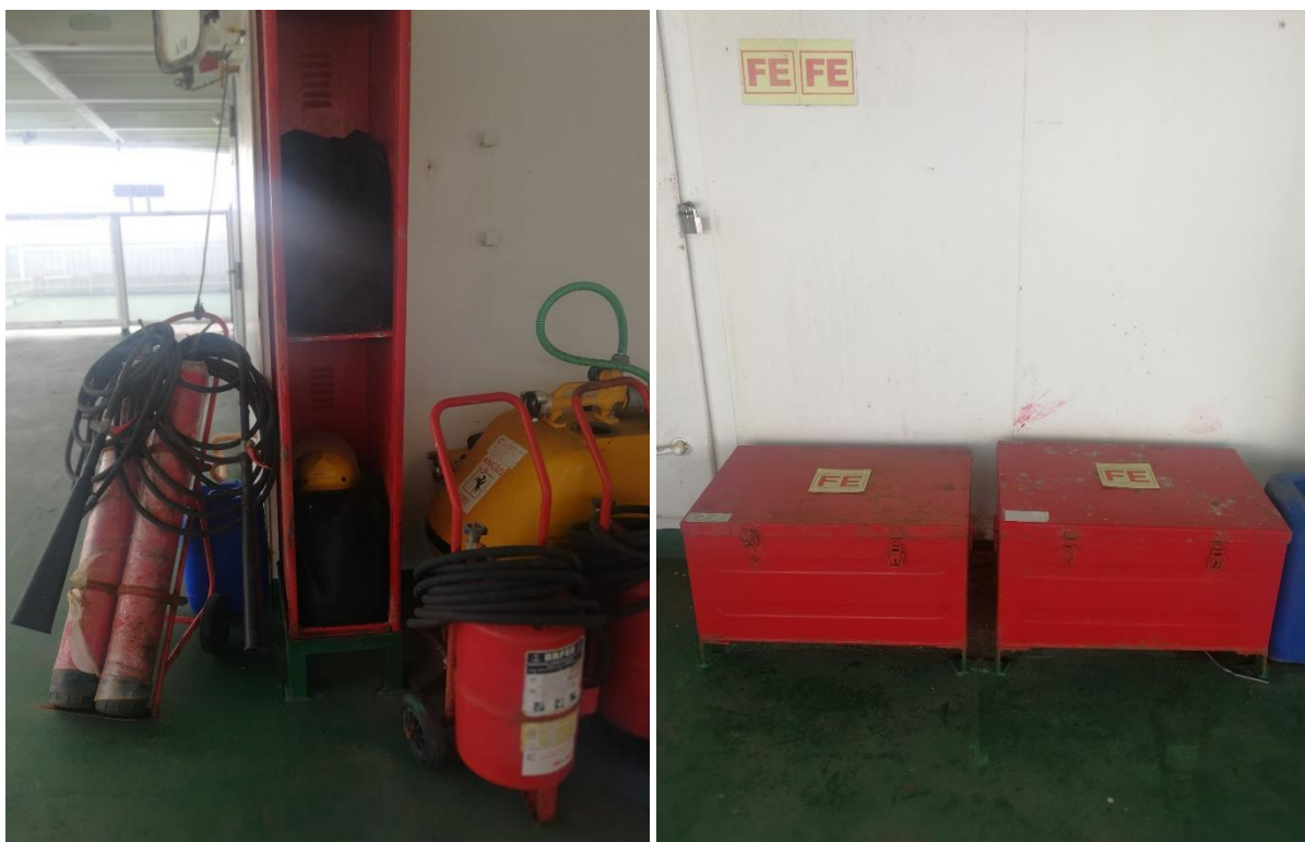
Ilustración 75. Equipos de bomberos helipuerto. Fuente propia.
