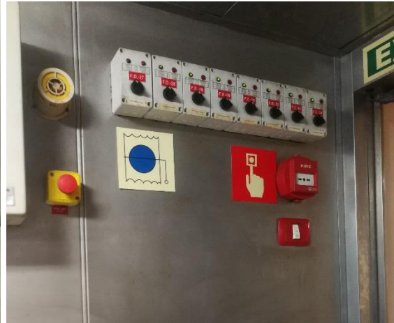
Ilustración 64. Fire dampers de la cocina. Fuente propia.
