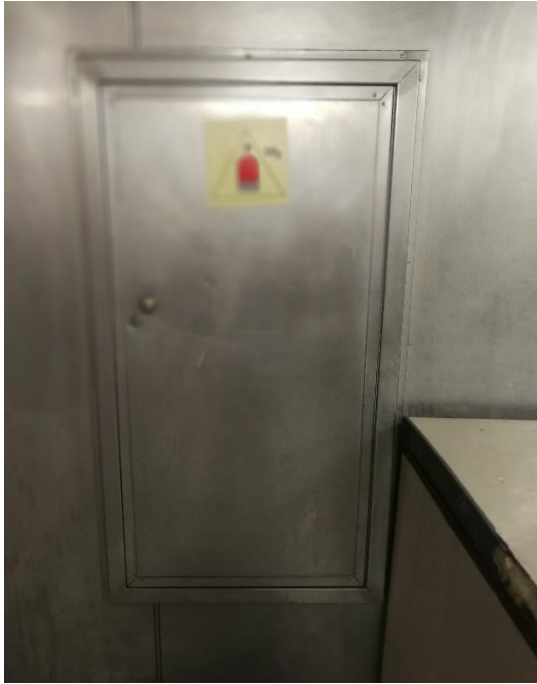
Ilustración 63. Armario CO 2 de la cocina. Fuente propia
