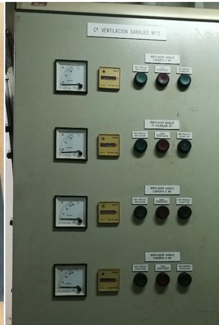
Ilustración 80. Ventilación tronco escalera de proa. Fuente propia.
