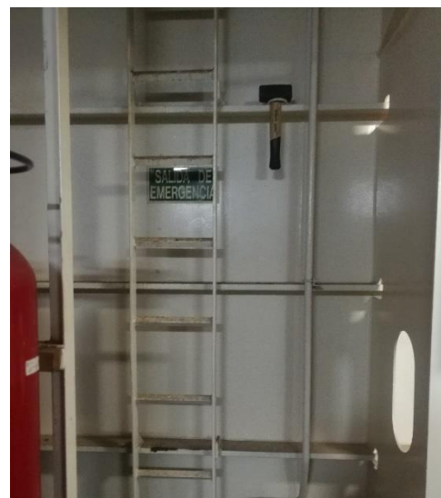
Ilustración 59. Salida/entrada emergencia local CO 2 . Fuente propia.
