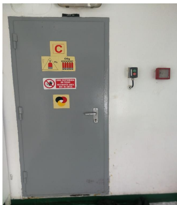
Ilustración 52. Puerta local CO 2 de la máquina. Fuente propia.
