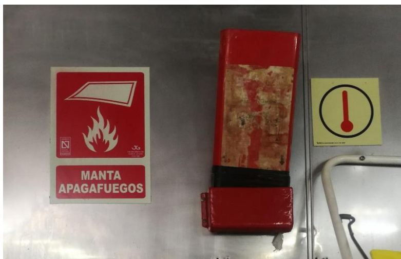
Ilustración 72. Manta apaga fuegos de la cocina. Fuente propia.
