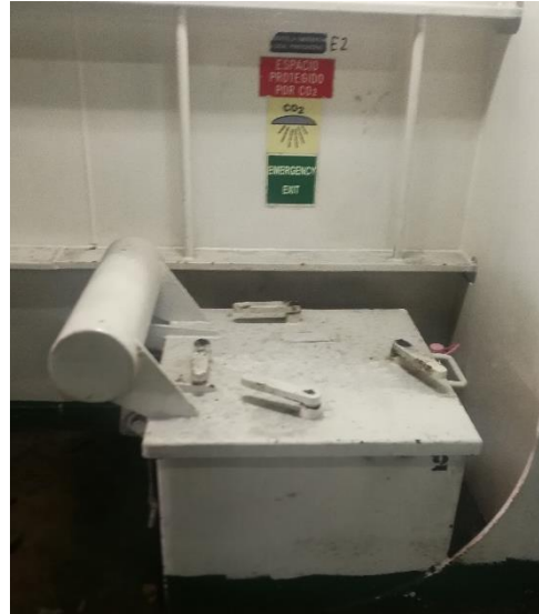
Ilustración 92. Tambucho de salida de emergencia de la máquina. Fuente propia.
