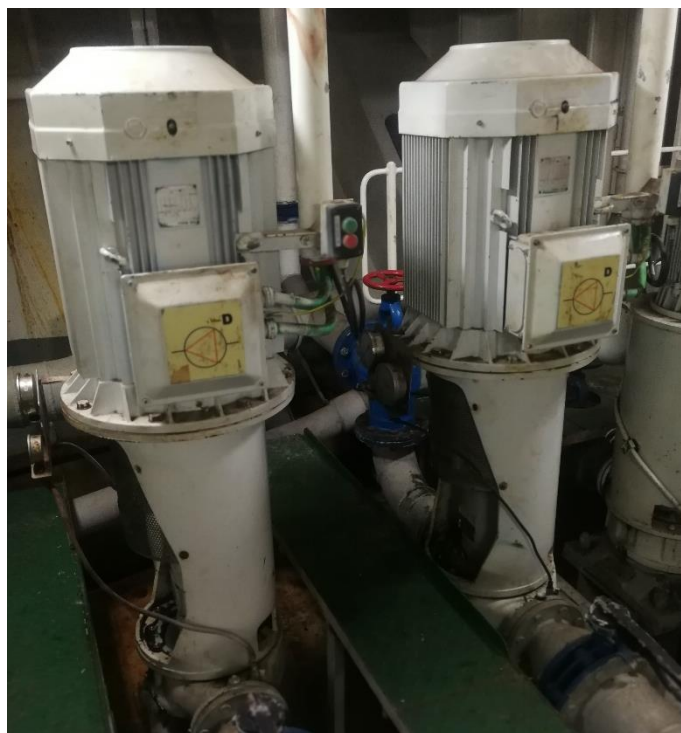
Ilustración 49. Bombas de los rociadores de garaje. Fuente propia.
