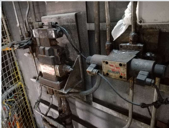
Foto: Electroválvulas control rampa popa. Elaboración propia
