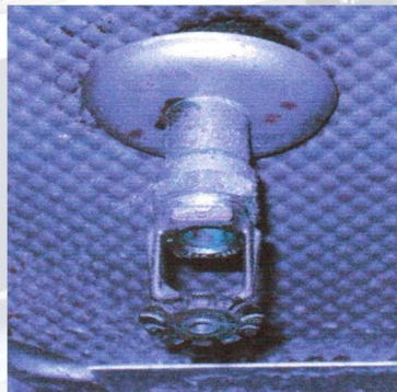
Foto: Rociador de garaje. Elaboración propia
