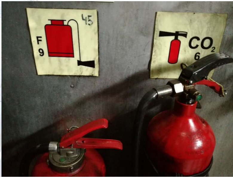
Foto: Extintor CO2 y agua+aditivo sala máquinas. Elaboración propia
