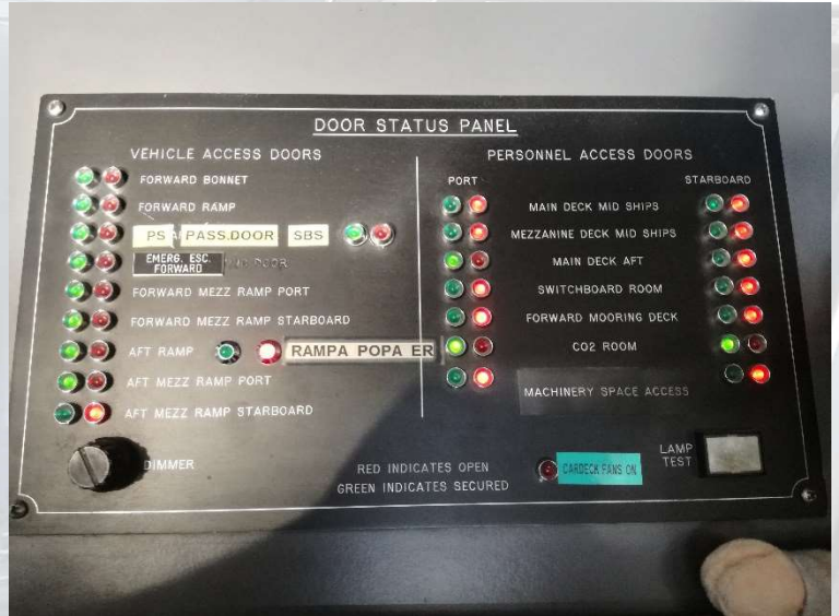
Foto: panel de estado puertas C.I. Elaboración propia
