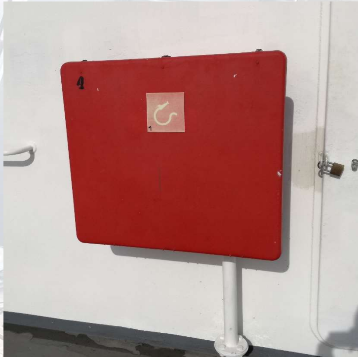
Foto: Hidrante N°4. Elaboración propia
