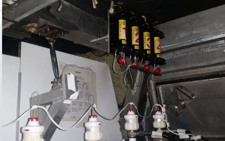
Foto: Bombas "HAMMAR" lanzamiento balsas. Elaboración propia
