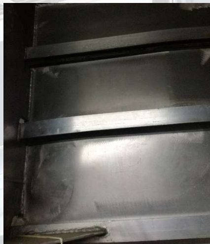
Foto: Refuerzo longitudinal abombado. Elaboración propia
