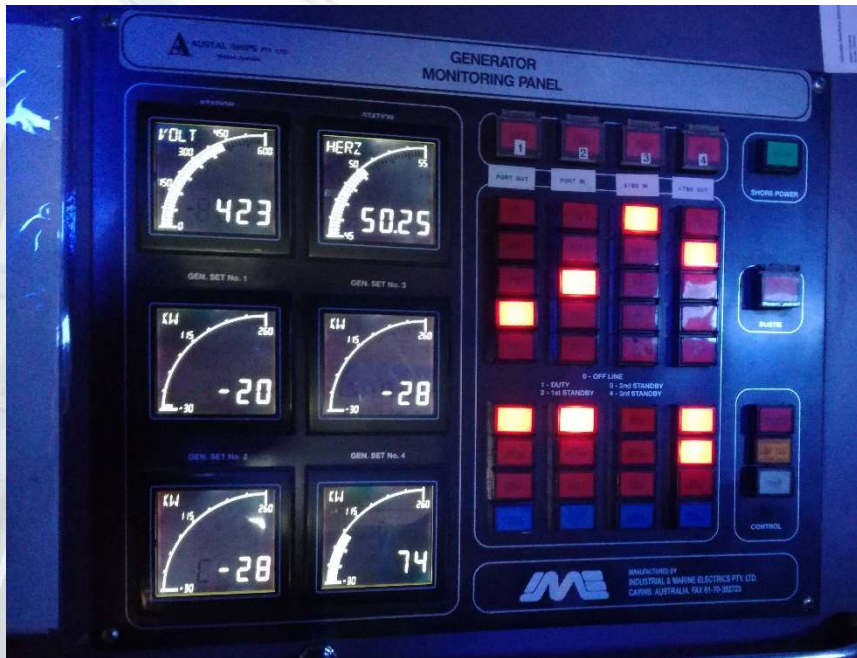
Foto: Consola generadores. Elaboración propia
