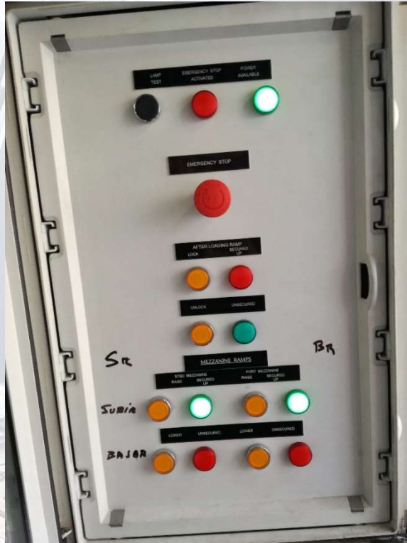
Foto: Consola control rampas de popa cardeck. Elaboración propia
