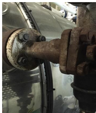
Ilustración 35: Corrosión. Fuente propia
