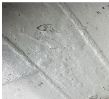
Ilustración 28: Ampollado. Fuente propia
