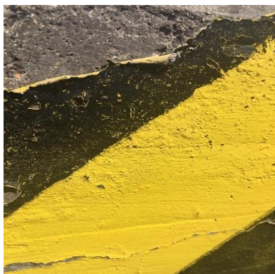
Ilustración 27: Desprendimiento de la pintura. Fuente propia
