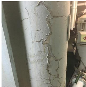
Ilustración 32: Grietas. Fuente propia
