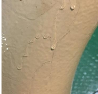
Ilustración 37: Descuelgues. Fuente propia
