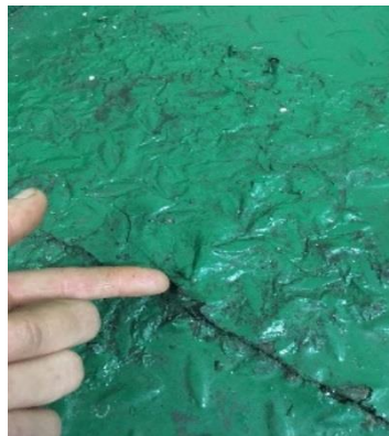
Ilustración 30: Falta de adherencia. Fuente propia
