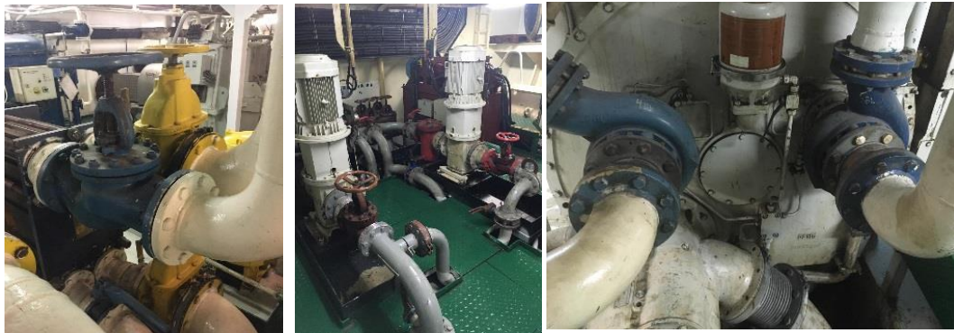
Ilustración 26: colores de diferentes equipos en sala de máquinas. Fuente propia
