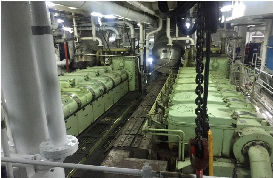
Ilustración 14 Sala de Máquinas V. Teide. Fuente: Trabajo de Campo
