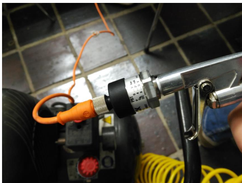
Figura 4.25: Sensor de presión SICK conectado al compresor
