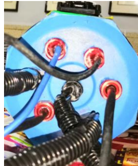
Figura 4.22. Tubos corrugados para agrupar cables
