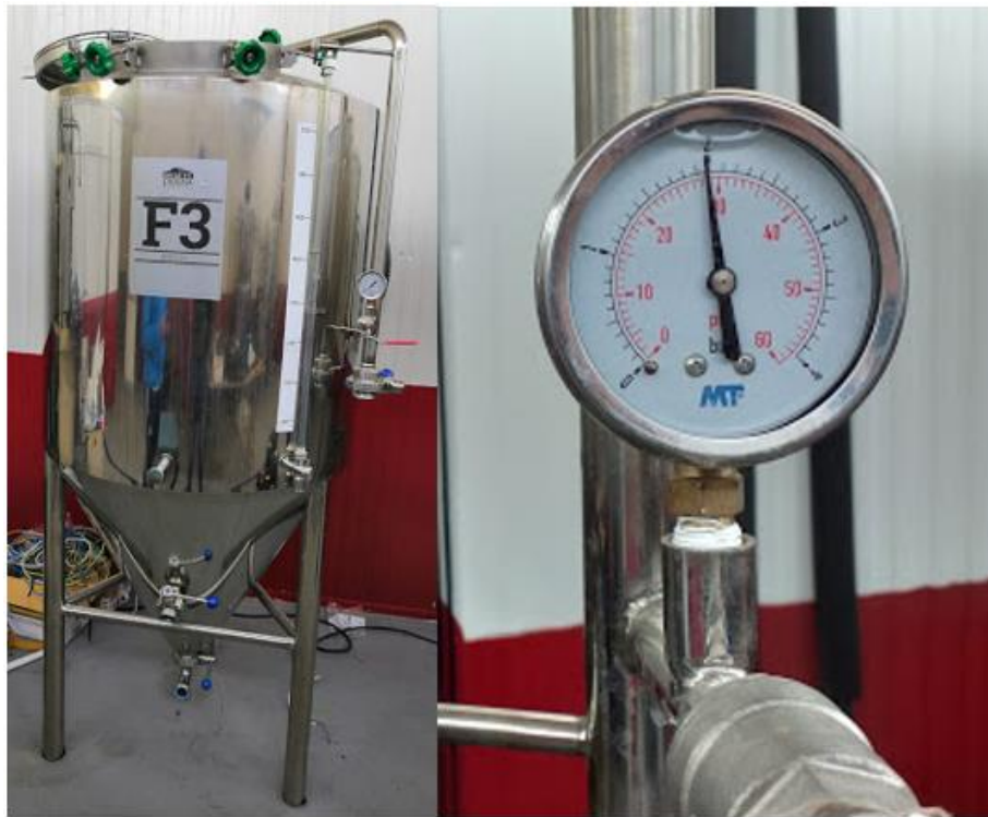
Figura 5.4. Tanque de presión a la izquierda y manómetro a 2 bares a la derecha
