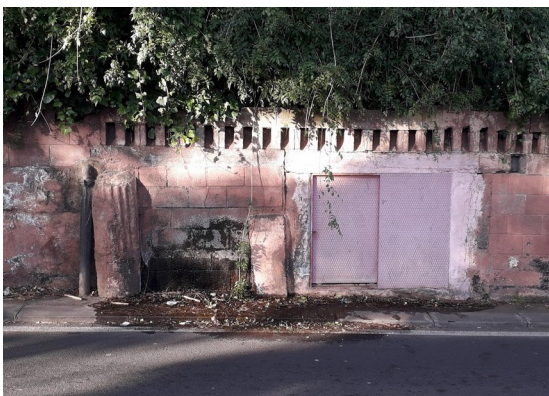
Uno de los acoples de la bajante con una fuga de agua
