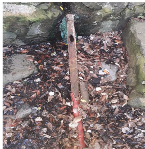
Tubería antigua de la fuente El Chupadero
