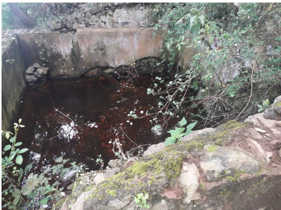
Aljibe de la fuente El Chupadero deteriorado por el paso del tiempo
