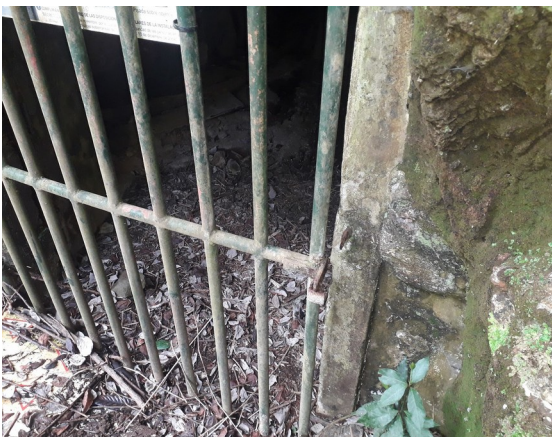
Entrada de la galería Los Palomos. Se observa que el barro es lo único que mantiene la puerta cerrada
