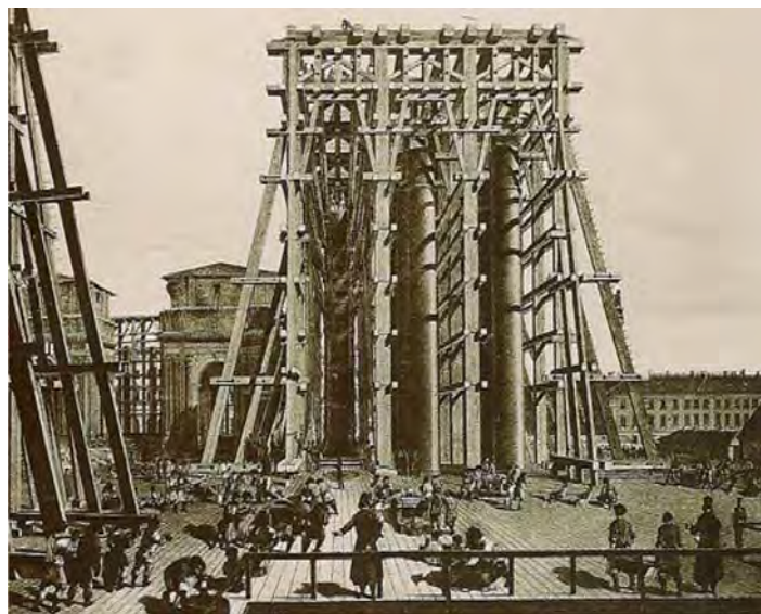
Figura 17. Andamios diseñados por A. Betancourt para instalar las columnas de granito de la catedral de San Isaac.
