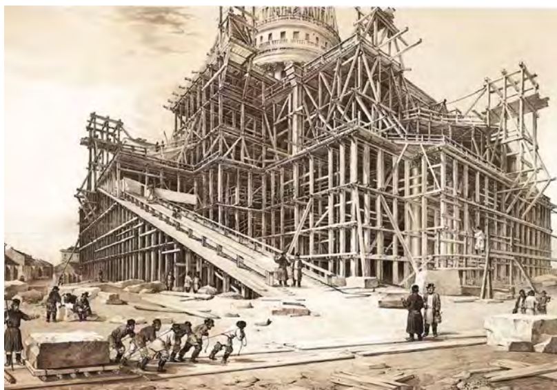
Figura 16. Andamios diseñados por A. Betancourt para la construcción de la catedral de San Isaac.
