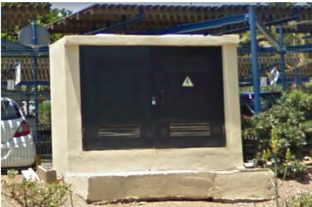
Ilustración 10: Cuadro eléctrico para la instalación. Fuente: GRAFCAN.
