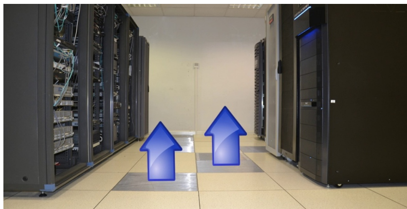
Figura 7: Sistema de ventilación en suelo técnico en sala CPD
