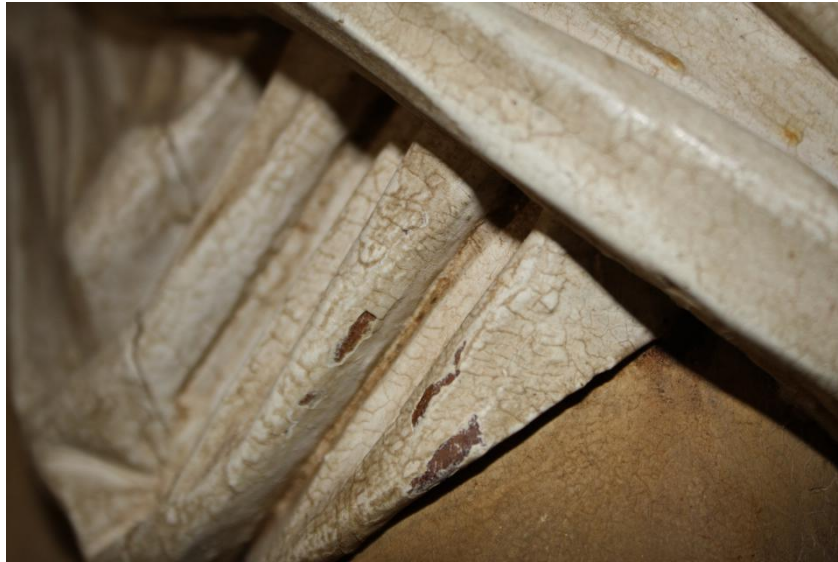
Figura 311. Detalle de las craqueladuras.
