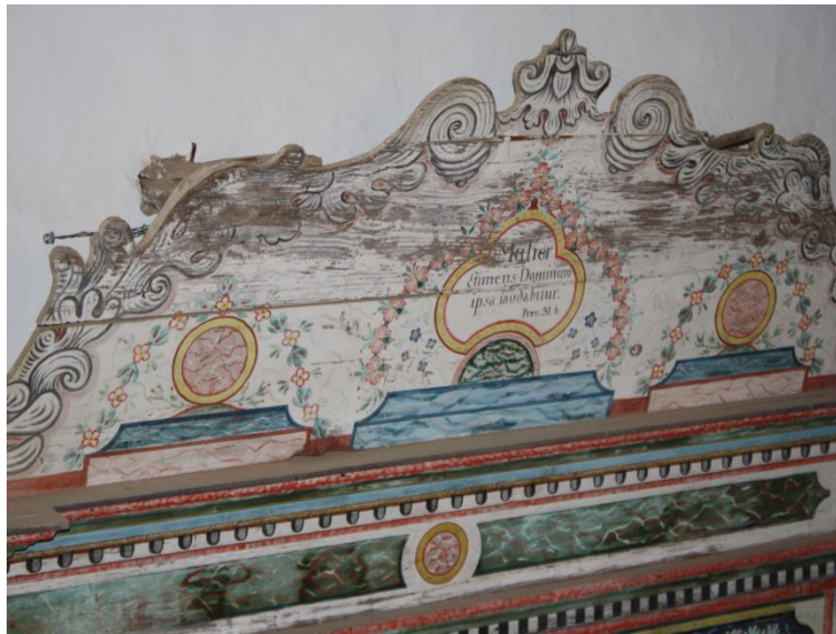
Figura 274. Pérdida parcial de la policromía en la coronación.
