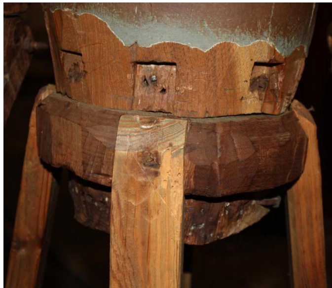
Figura 313. Alteración de la colocación original de la estructura de candelero.
