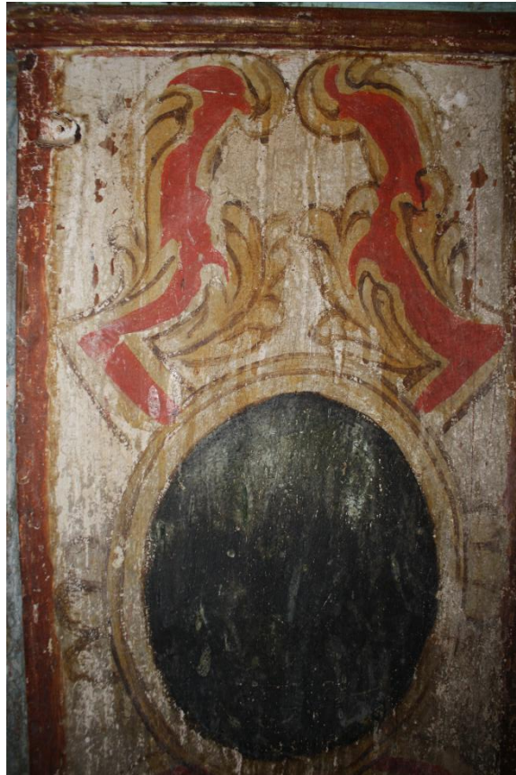
Figura 134. Amarilleamiento de la capa de protección. Sotabanco, lado de la epístola.
