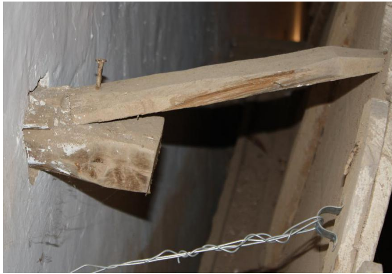
Figura 62. Riostra anclada al muro y reforzada mediante cuñas.
