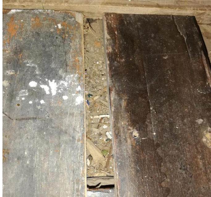
Figura 286. Acumulación de escombros y suciedad ambiental. Mesa del Altar.
