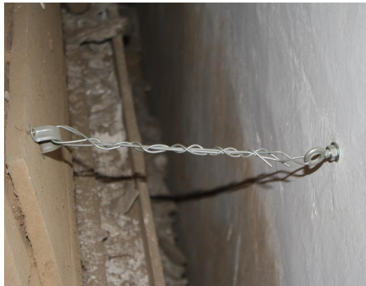
Figura 61. Detalle del alambre que sostiene la coronación. Retablo de Animas.
