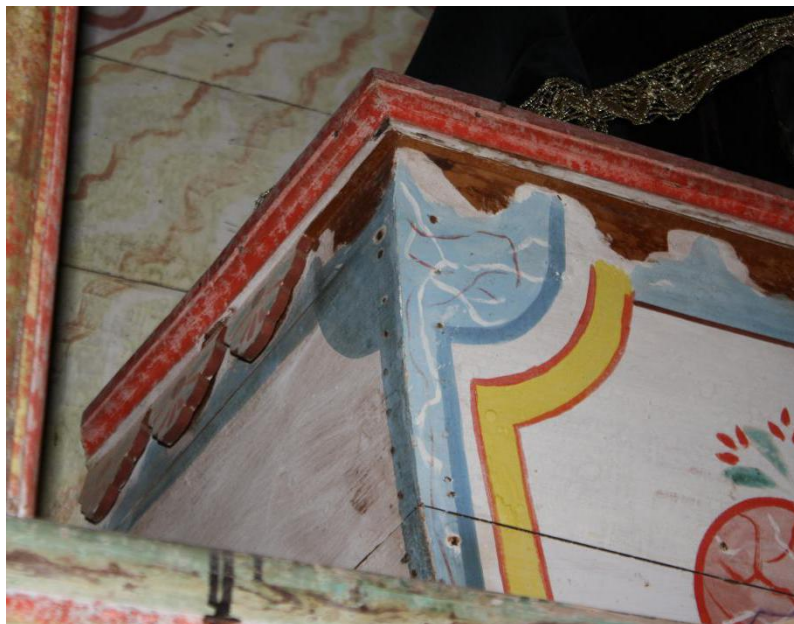
Figura 281. Pérdida volumétrica de los dentallones.
