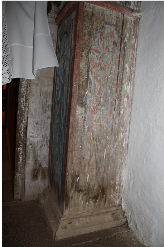
Figura 138. Pérdida de la policromía de la zona del sotabanco.
