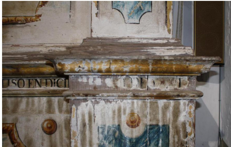
Figura 234. Detalle del fragmento afectado por la humedad "...finaliso en diciembre de [...] 1...1 (1791).
