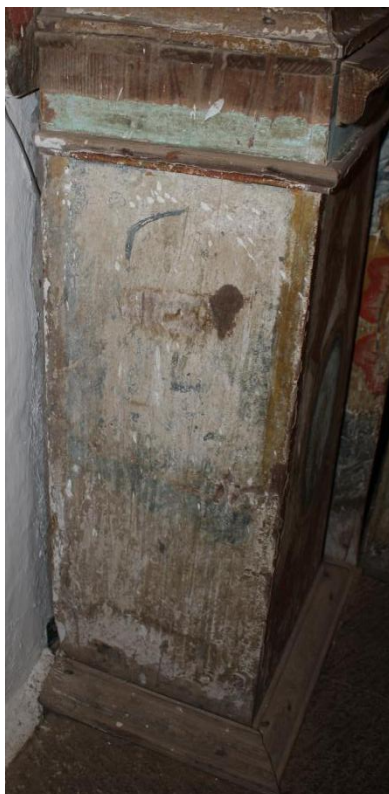
Figura 268. Desaparición de la policromía por efectos de la humedad y envejecimiento.
