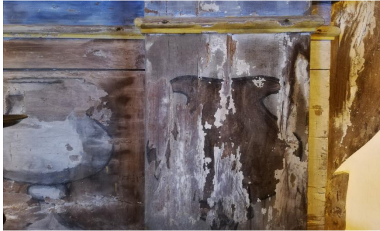
Figura 141. Manchas de humedad que afectan a la zona del banco.
