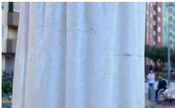
Fig. 40. Fisura encontrada en la parte trasera de la obra
