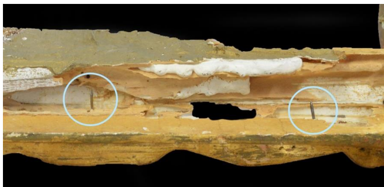
Figura 43: Clavos de unión de las molduras interiores a los embones principales. Apreciable gracias a la pérdida de soporte provocada por los xilófagos.
