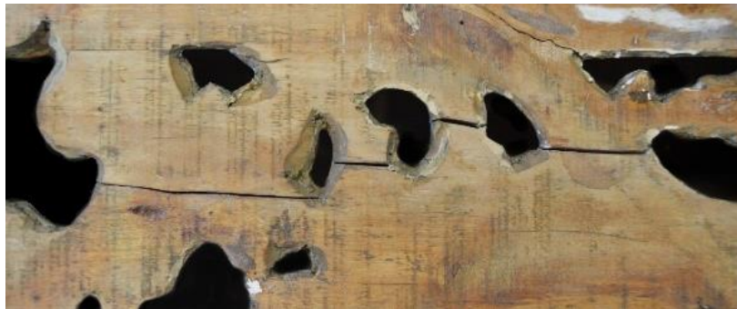
Figura 60: Además, destacan cuatro fendas ubicadas en el larguero derecho posterior alcanzando la mayor 10 cm de longitud, un grosor de 2 mm y profundizando hasta llegar al dorado.
