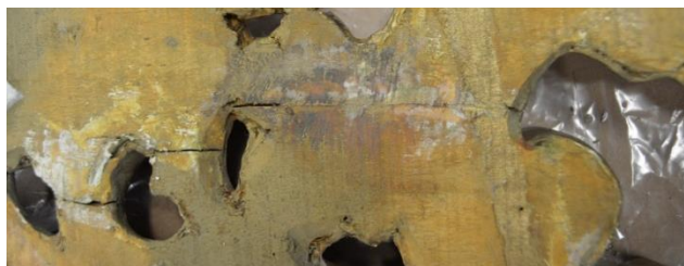
Figura 239: Aspecto de una de las zonas del larguero derecho, en el que se habían originado las fendas que vimos en el estado de conservación (figura 60, página 46) y en una de las intervenciones fueron cubiertas por una masilla y estuco, quedando estos al descubierto al retirar el repinte.
