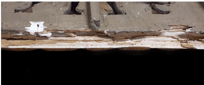
Figura 72: Detalle de las pérdidas provocadas por los xilófagos en el rebaje y galce inferiores desde la trasera del marco.
