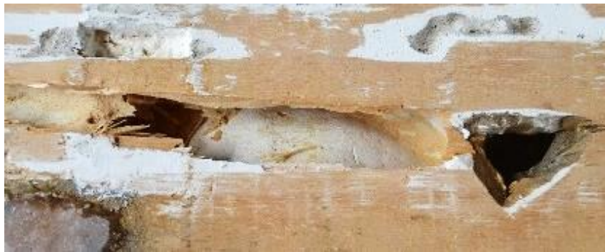
Figura 75: Detalle del interior de una bolsa de detritus tras su limpieza en el que descubrimos que las termitas habían terminado con cualquier resto de soporte leñoso, dejando únicamente un cascarón con la preparación y el dorado en algunas zonas.
