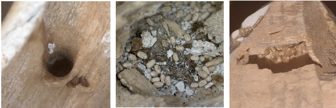
Figuras 66-68: A la izq. orificio creado por termita con un diámetro de aproximadamente 3 mm y a su derecha detalle de toma microscópica del interior de un canal de paso de en el que se puede observar la suciedad general, restos de madera y yeso de una intervención anterior junto a detritus. Por último, toma macroscópica del interior de una galería en la que encontramos varias termitas muertas.
