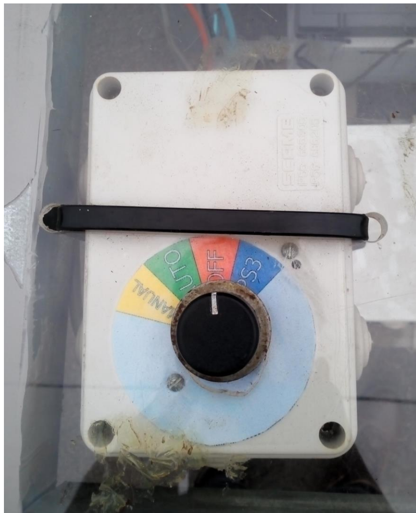
Figura 18 – Selector de estados del panel principal
