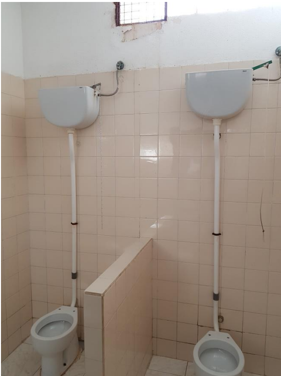
Tanques altos con peligro de caída de los mismos sobre los profesores y alumnos.
