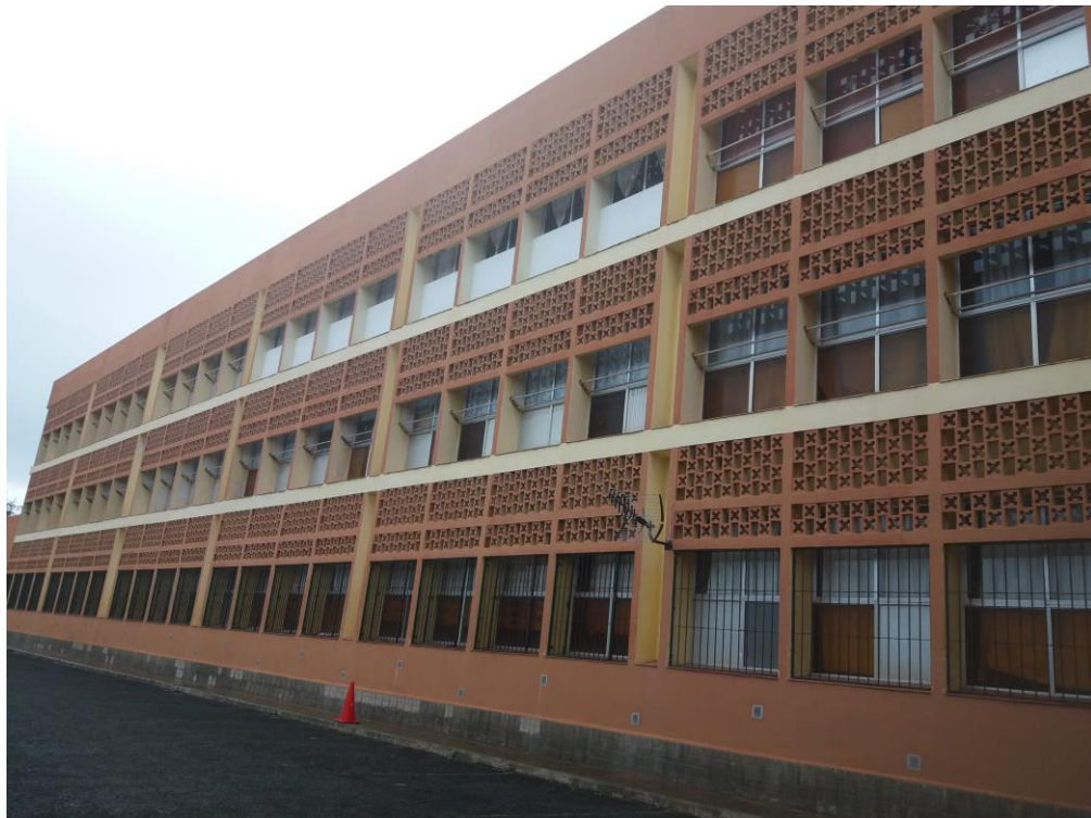
Fachada norte. Podemos observar el mal estado de la carpintería de las ventanas.
