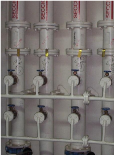
Ilustración 19 Válvulas de rociadores (elaboración propia) [ 7 ]
