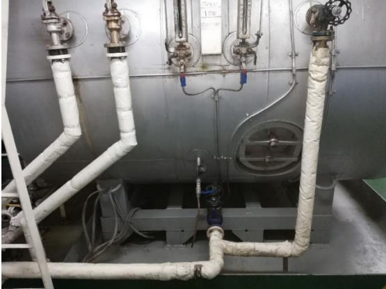
Ilustración 29 Tuberías con aislamiento térmico (elaboración propia) [ 7 ]
