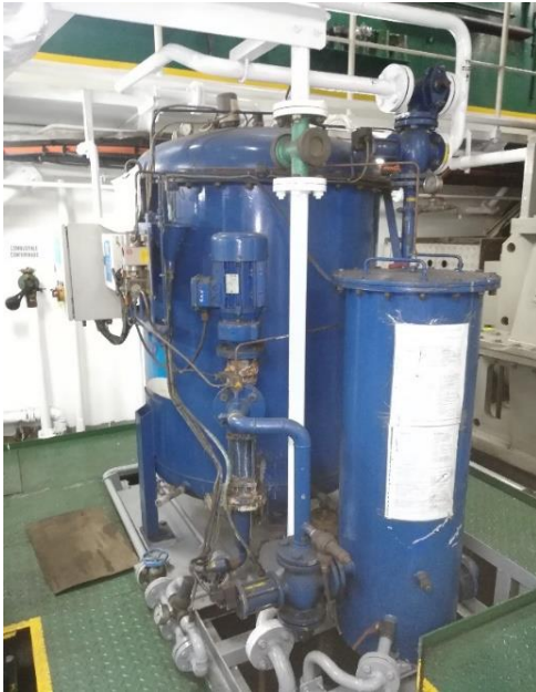
Ilustración 23 Separador de sentinas (elaboración propia) [ 7 ]
