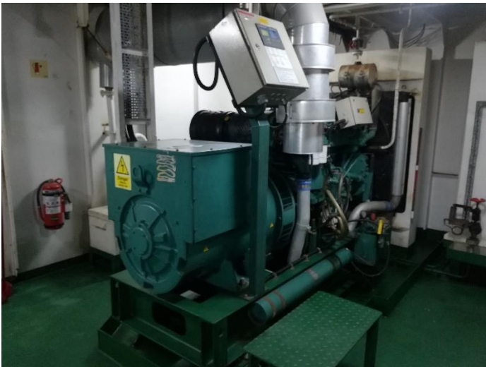
Ilustración 31 Generador de emergencia (elaboración propia) [ 7 ]
