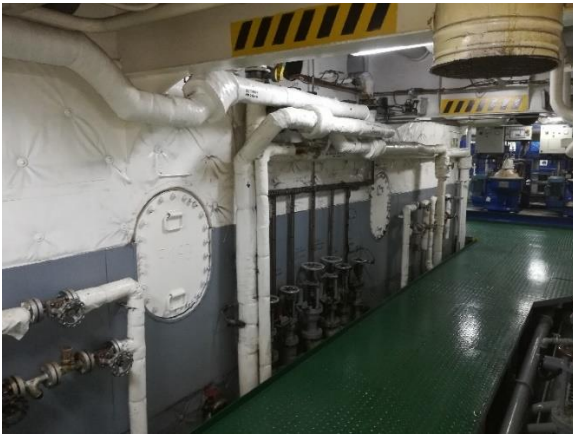
Ilustración 30 Tuberías de fuel con aislamiento térmico (elaboración propia) [ 7 ]
