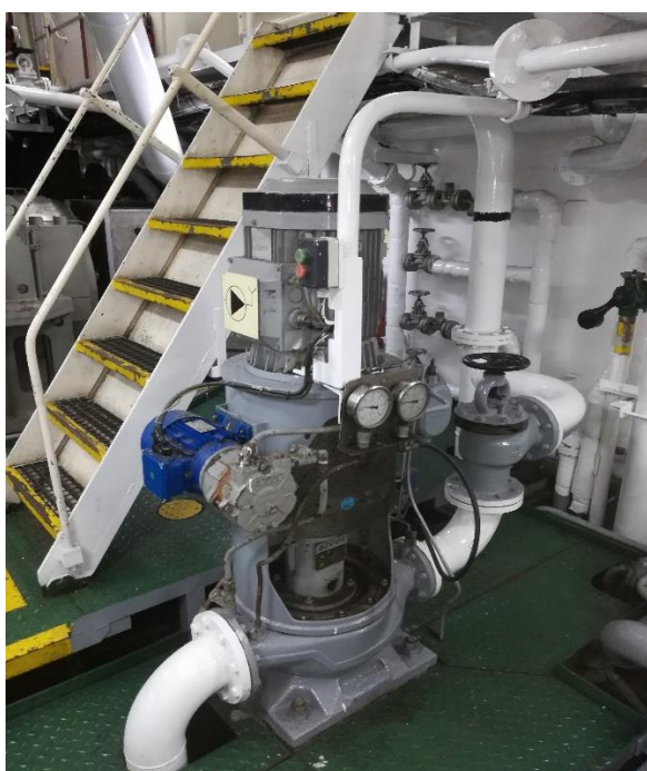
Ilustración 28 Bomba de achique de sentinas (elaboración propia) [ 7 ]
