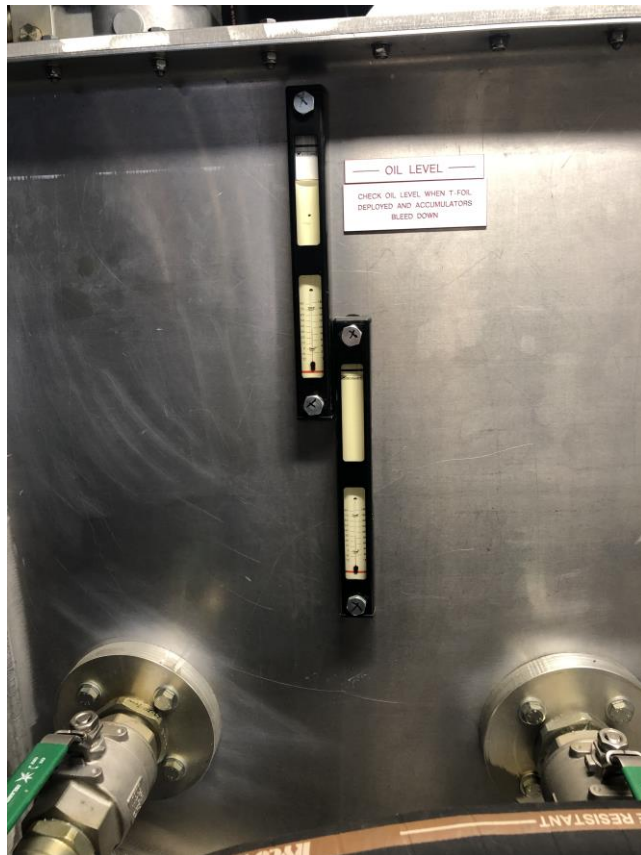
Ilustración 17-Tanque para aceite hidráulico proa. Visor de nivel alto y bajo. Fuente: Elaboración Propia
