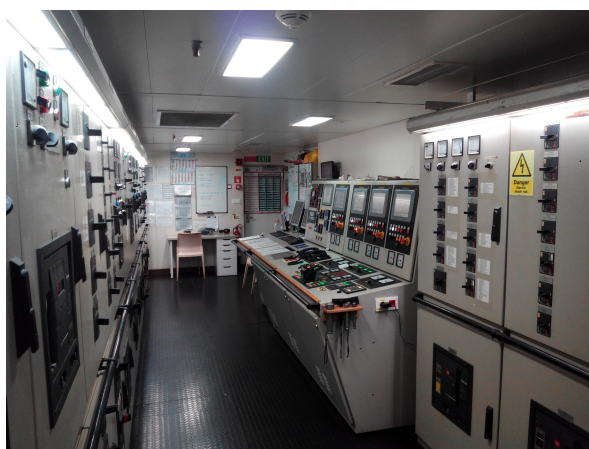
Ilustración nº 49: Control de máquinas Fuente: [10] [Trabajo de campo]
