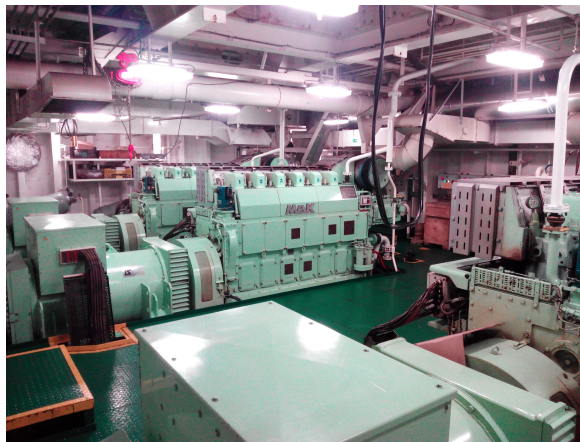
Ilustración nº 39: Motores auxiliares Fuente: [10] [Trabajo de campo]
