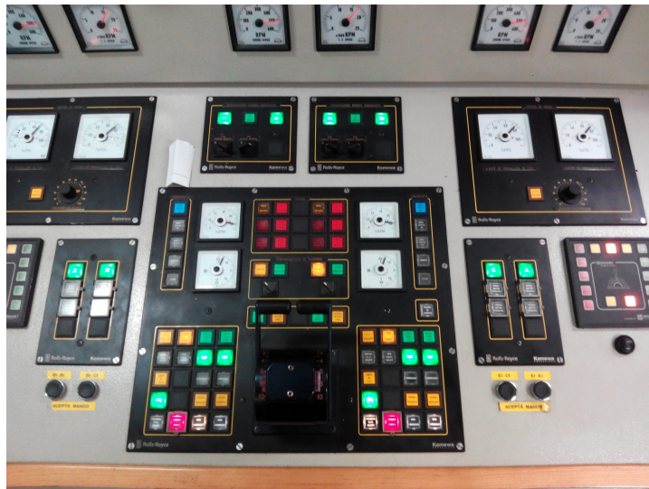
Ilustración nº 48: Cuadro de control Fuente: [10] [Trabajo de campo]
