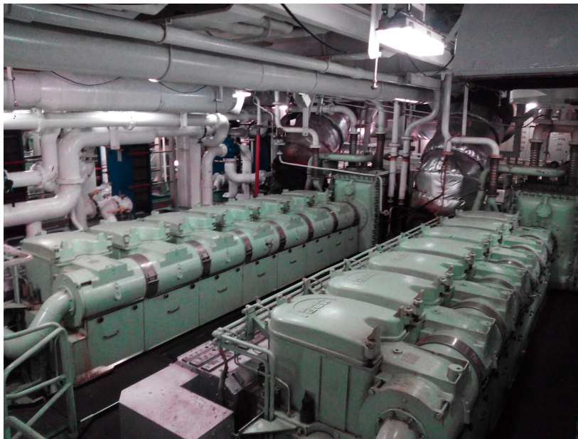
Ilustración nº 22: Motores principales 1 y 2 Fuente: [10] [Trabajo de campo]
