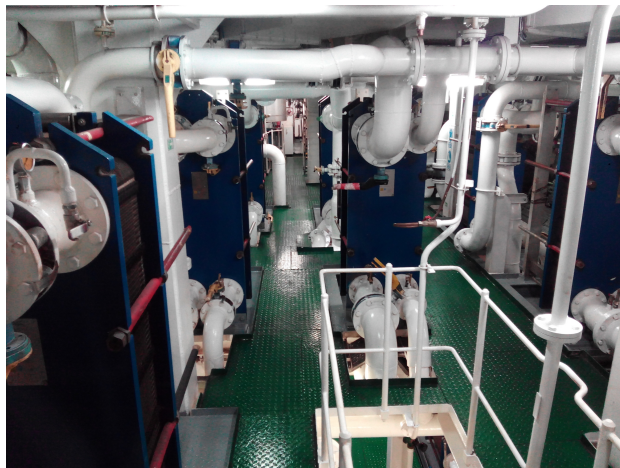
Ilustración nº 36: Líneas de refrigeración de agua MMPP Fuente: [10] [Trabajo de campo]
