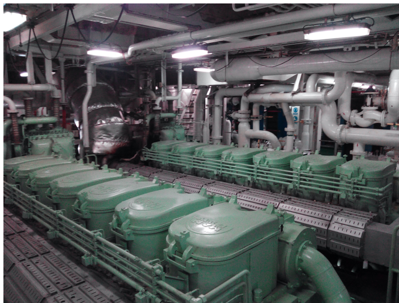
Ilustración nº 23: Motores principales 3 y 4 Fuente: [10] [Trabajo de campo]
