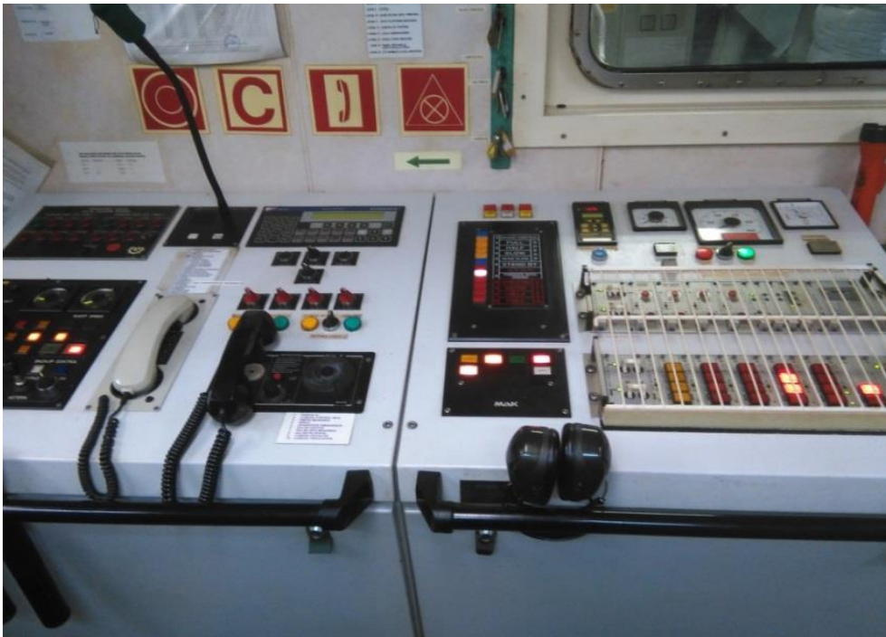
Imagen nº 22. Armario de pupitre en sala de máquinas.
