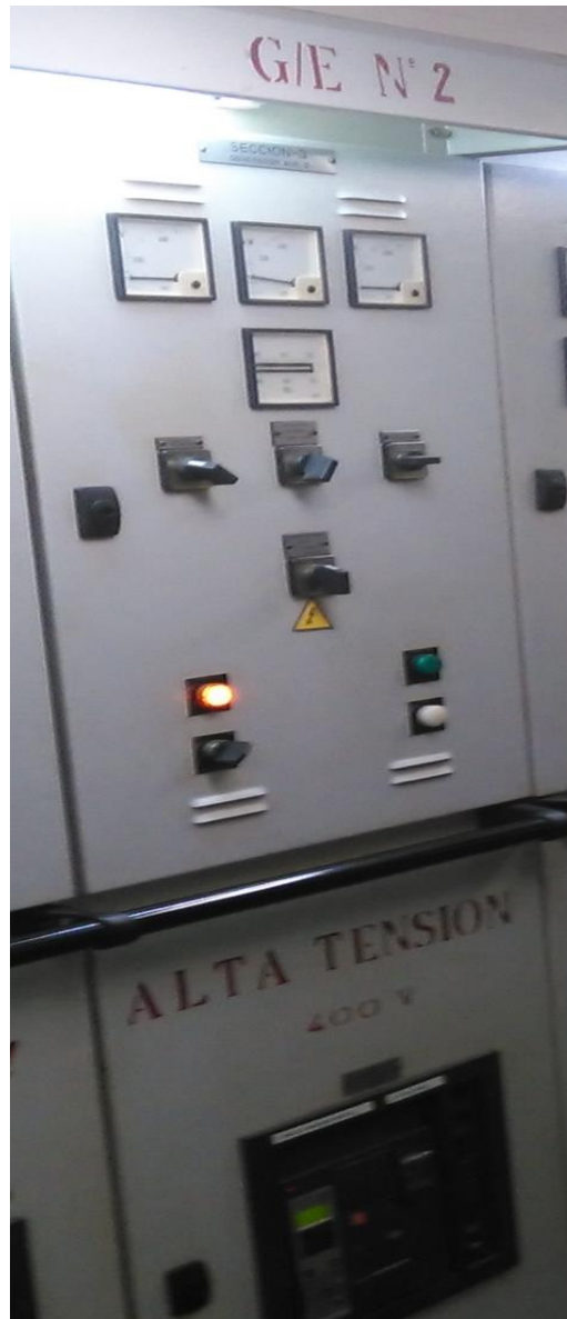
Imagen nº 141. Panel local motor auxiliar nº2.
