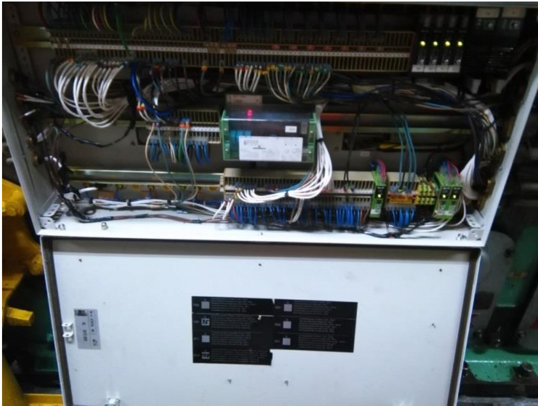
Imagen nº 144. Caja de terminales motor principal.
