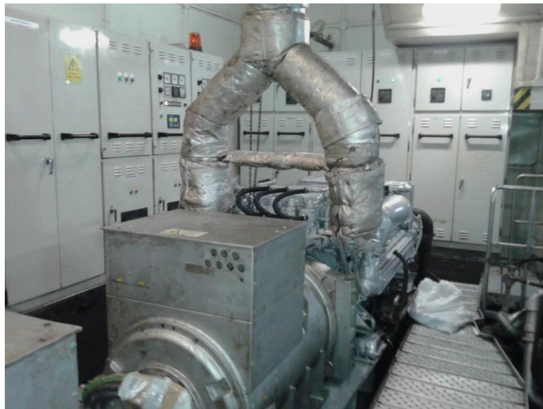
Imagen nº 132. Generador eléctrico sala de máquinas.
