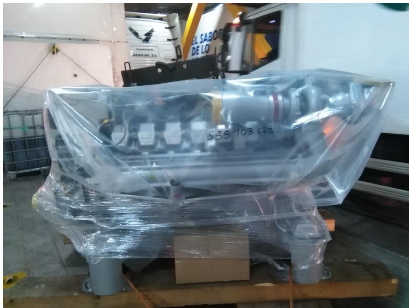
Imagen nº 140. Generador nuevo esperando a ser montado.
