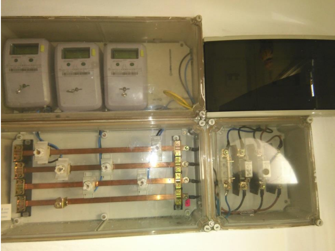
Imagen nº 20. Embarrado en viviendas.
