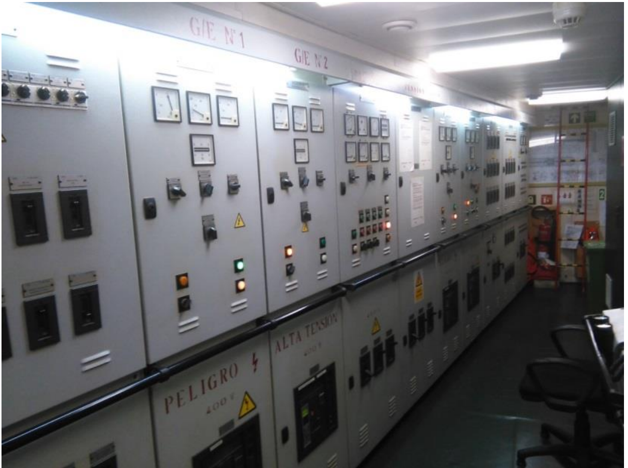
Imagen nº 21 Armarios murales en sala de control de máquinas.
