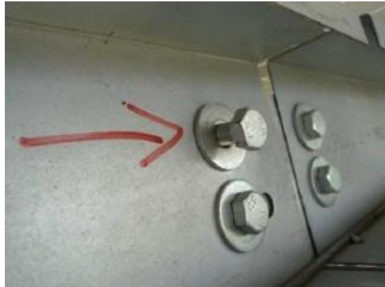
Ilustración 36: Ejemplo de fijación incorrecta. [26]
