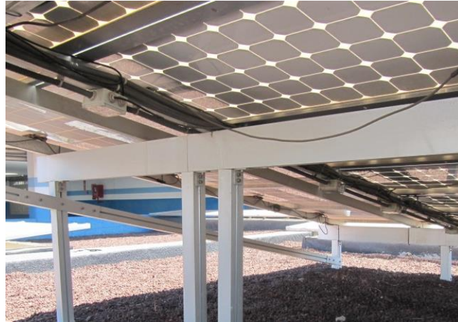
Ilustración 29: Ausencia de elementos de protección. [30]
