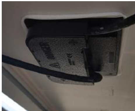
Ilustración 38: Ejemplo de curvatura insuficiente de un cable. [29]
