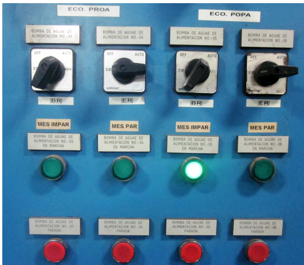
Figura 4.18: Cuadro de control economizadores Fuente: Autoría propia
