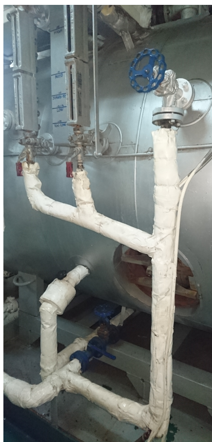
Figura 1.13: Válvulas de extracción Fuente: Autoría propia
