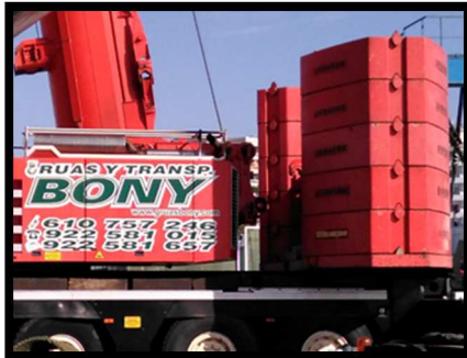
Ilustración n° 145. Cama de contrapesos desacoplada. Fuente: Trabajo de campo.
