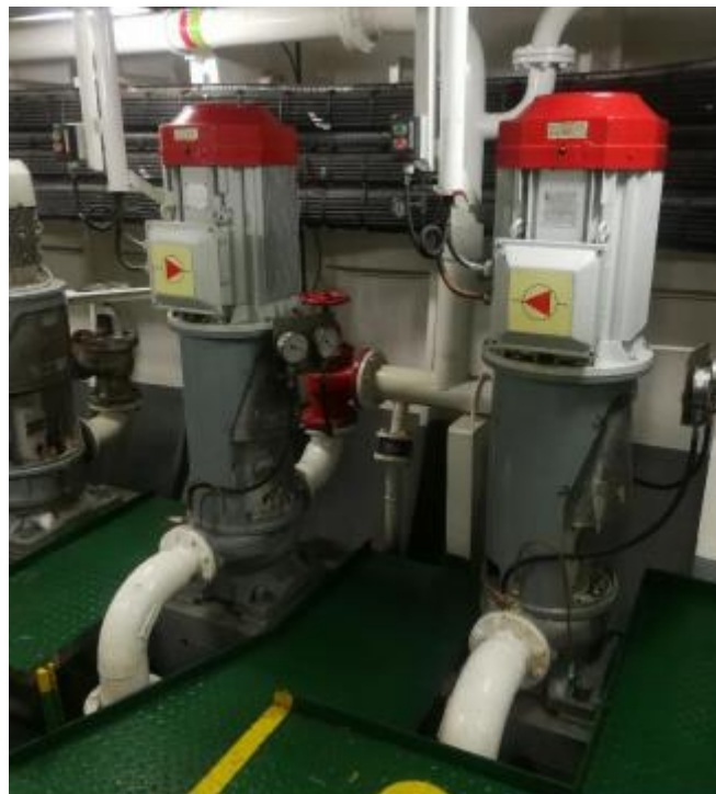
Ilustración 8: Bombas CI - Fuente: trabajo de campo
