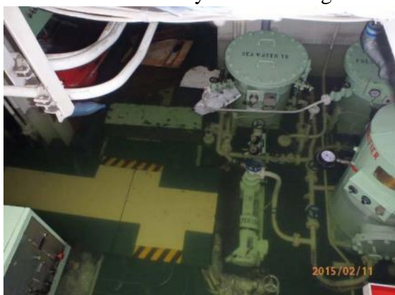
Ilustración 21: Inundación sala de máquinas 1 - Fuente: https://www.fomento.gob.es/organos-colegiados/ciaim
