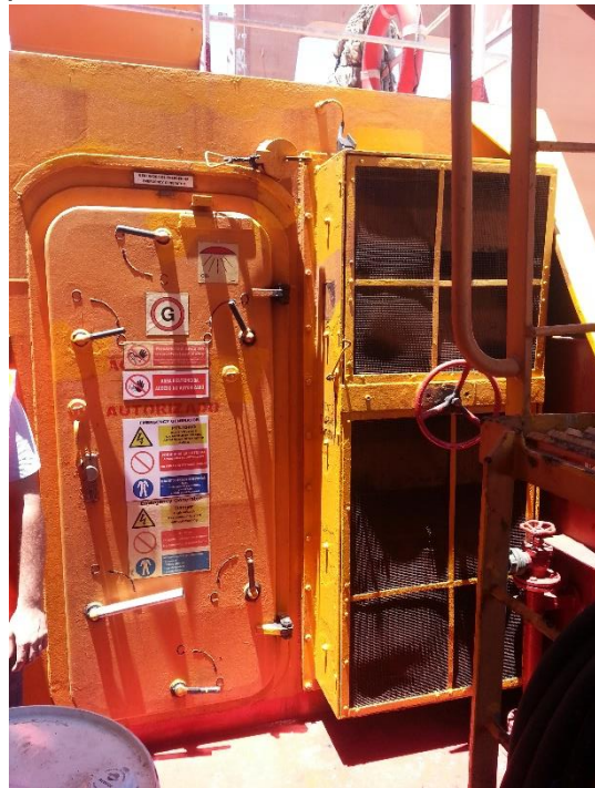
Ilustración 38: Entrada a la caseta del generador de emergencia. Fuente: Trabajo de campo
