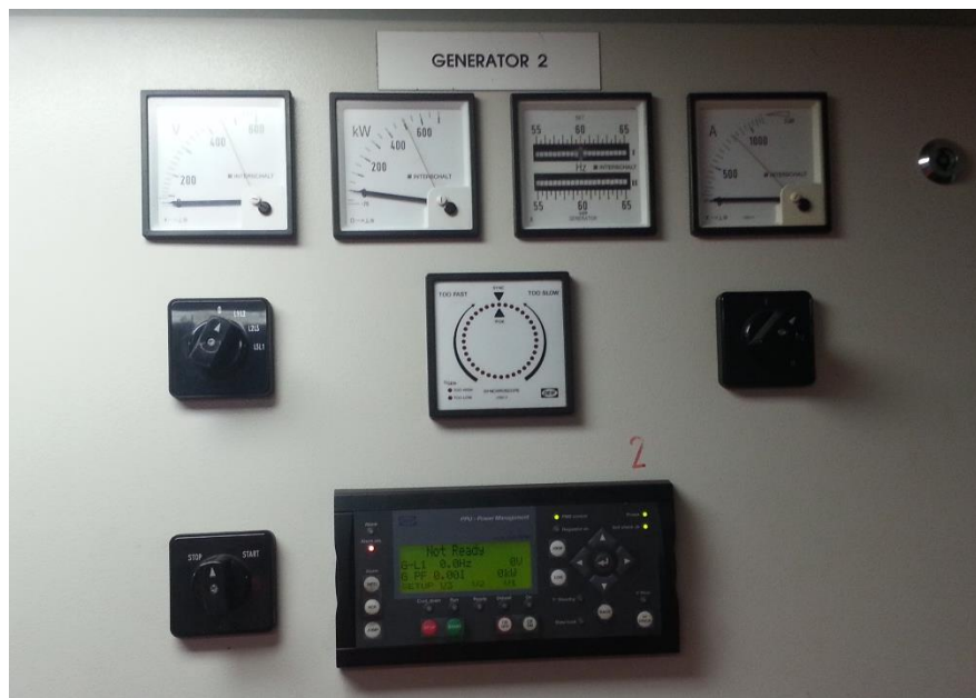
Ilustración 44: Vista del armario del generador 2. Fuente: Trabajo de campo
