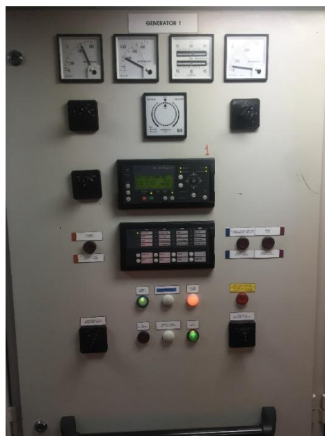
Ilustración 45: Armario del generador 1 y autómata maestro.
