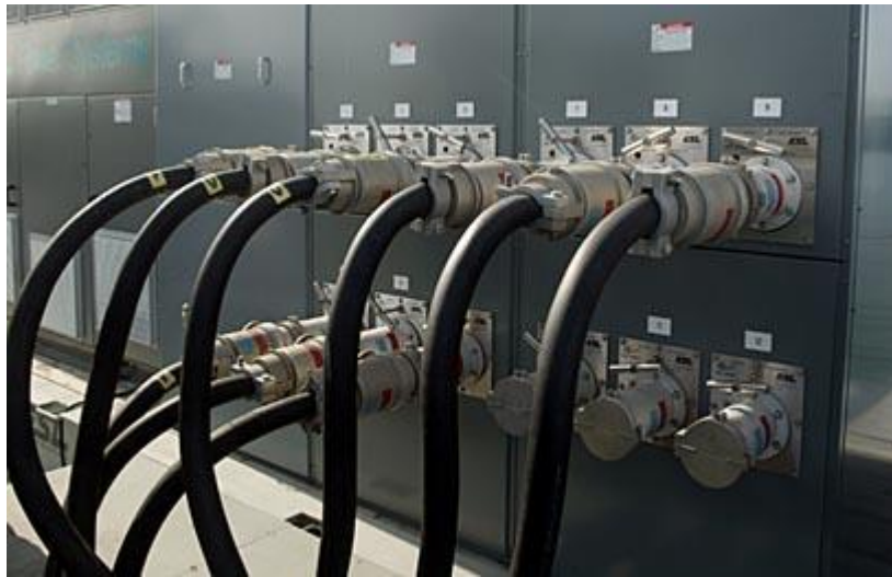
Ilustración 47: Conexión OPS 440 V. Fuente: (26)
