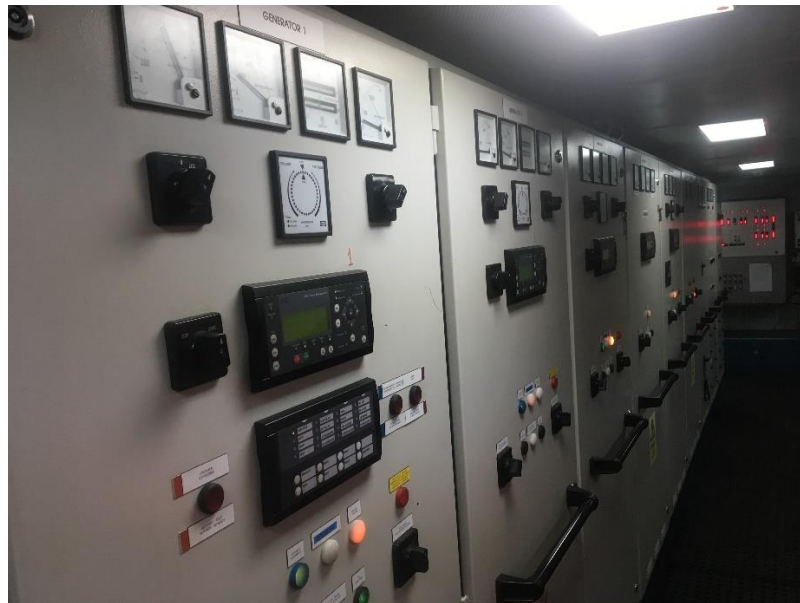
Ilustración 46: Vista de los 4 armarios de generadores.
