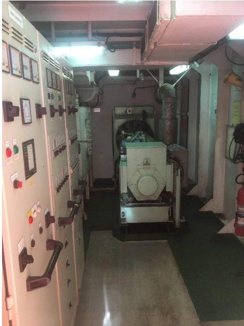
Ilustración 41: Generador de emergencia e interior de la caseta. Fuente: Trabajo de campo
