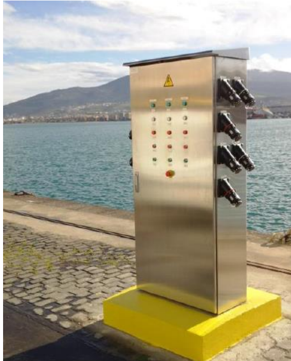
Ilustración 28: Caja de conexión para buque en Melilla. Fuente: (15)
