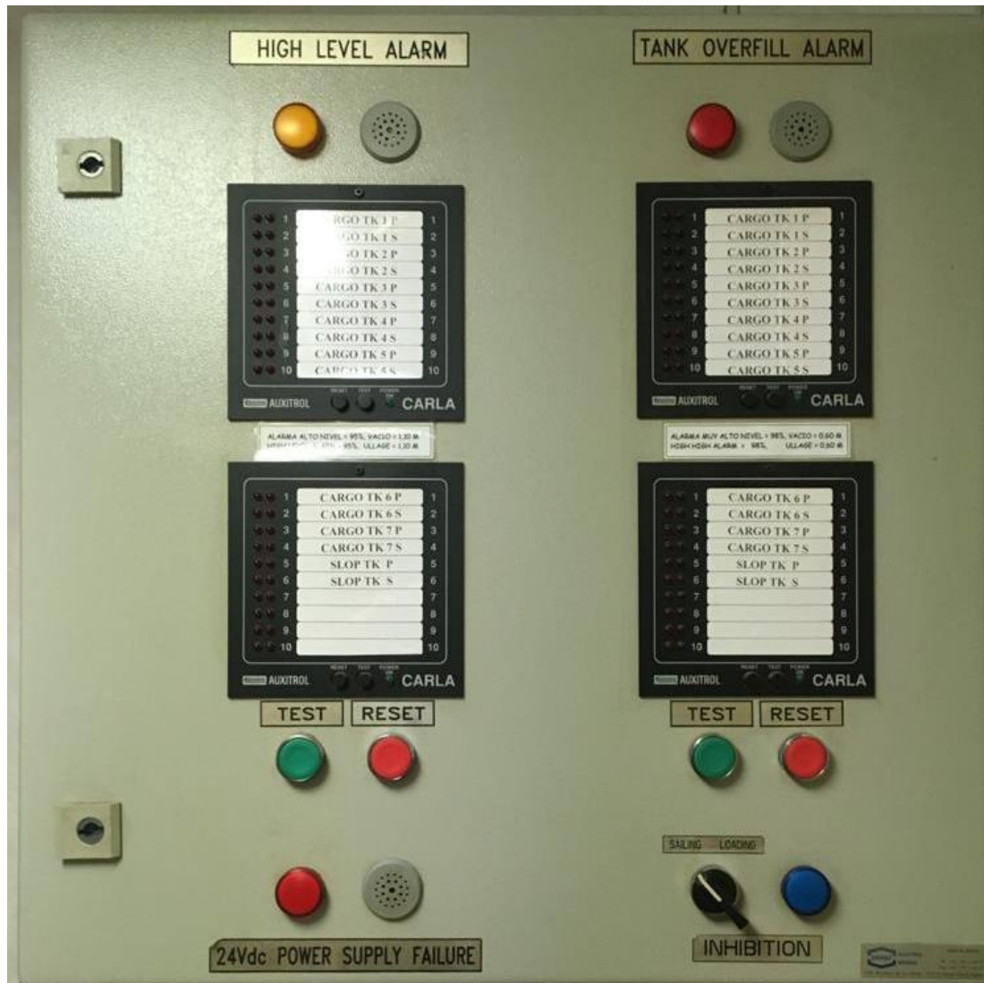
25 Panel de alarmas Hi y Hi-Hi level. Archivo: Pablo Fortuny
