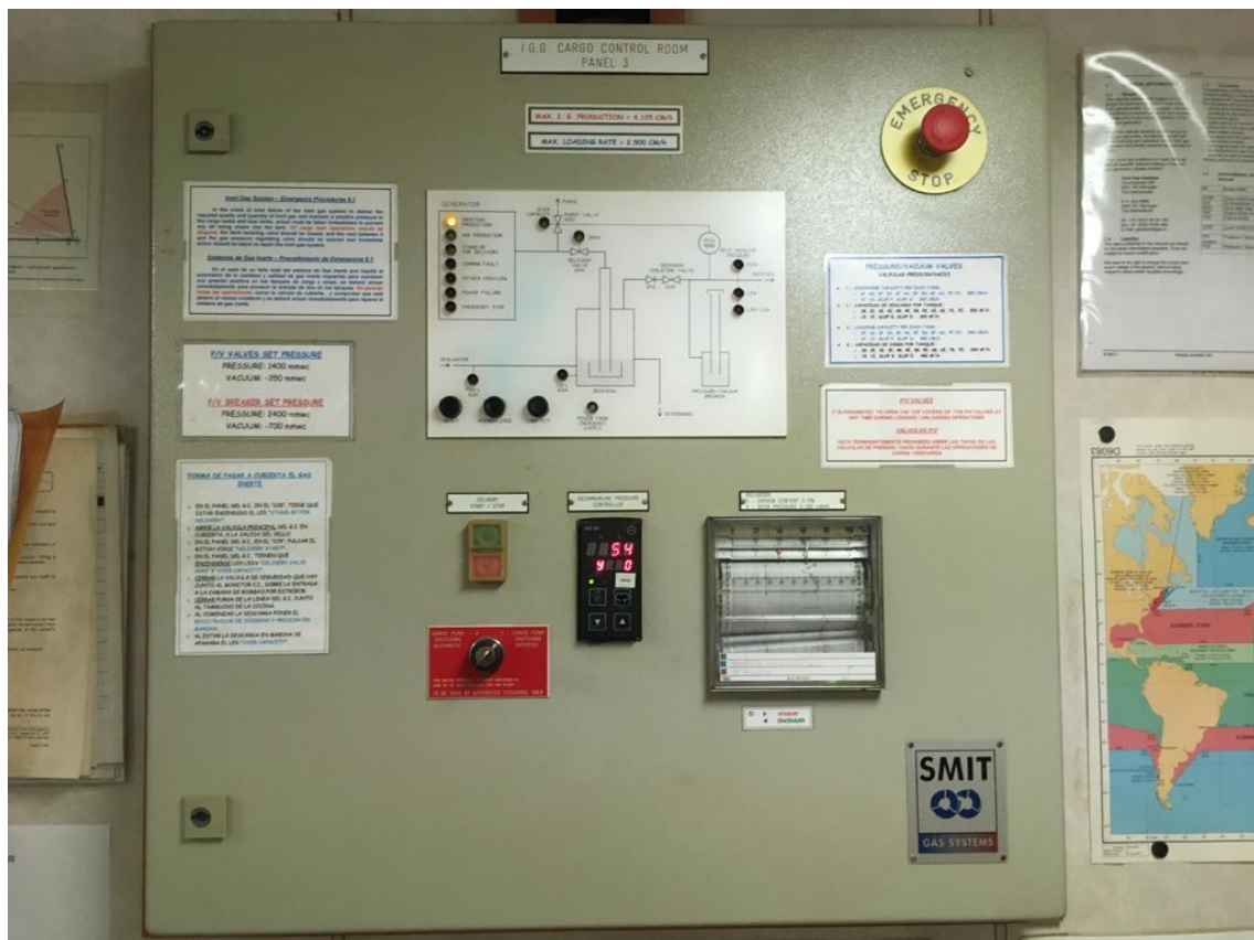
24 Panel de gas inerte en el control de carga. Archivo: Pablo Fortuny
