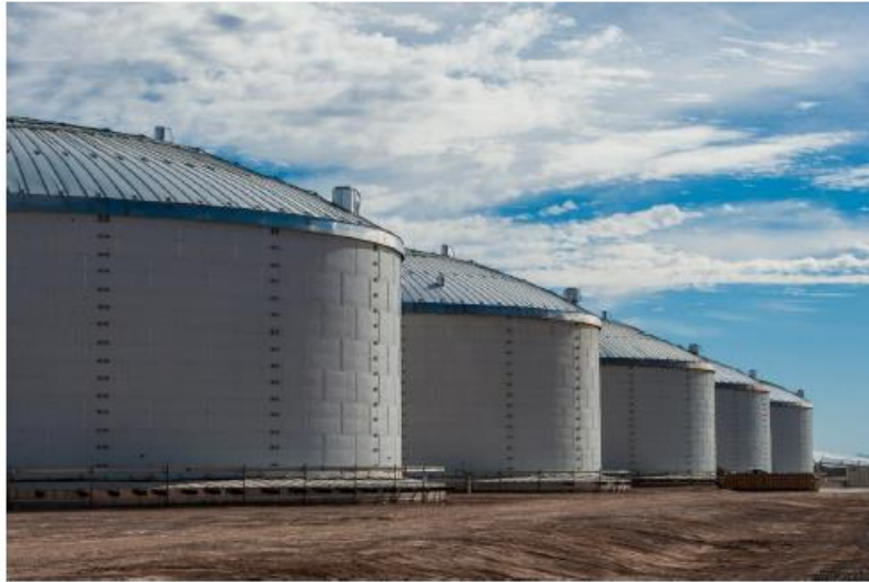
Figura 18: Tanques de almacenamiento de una planta CCP
