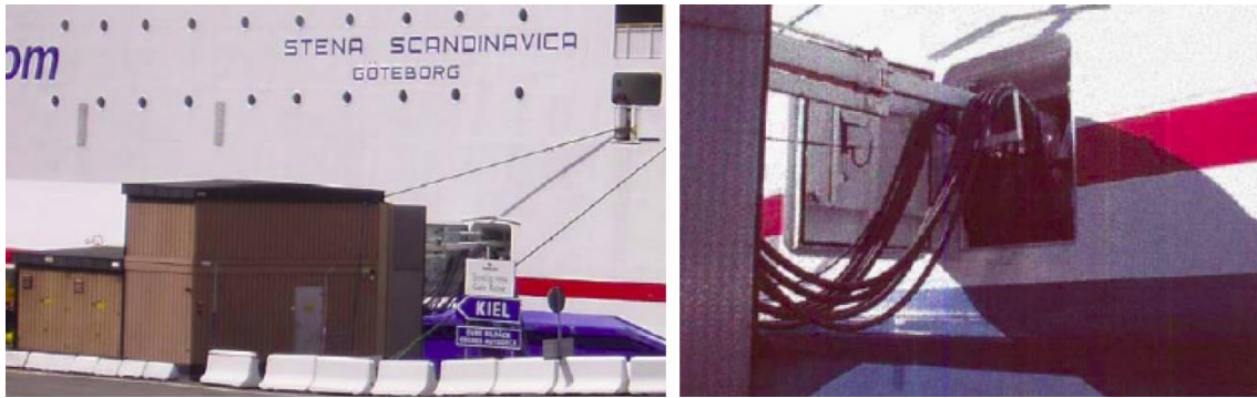
Ilustración 14. Instalación Cold Ironing en el puerto de Gotemburgo en 1989. Caseta con el transformador y cableado conectado al Stena Scandinavica. Fuente: chalmers.se (14)
