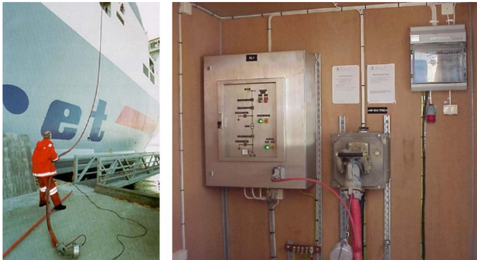
Ilustración 15. Conexión OPS en el puerto de Gotemburgo (2000). Fuente: chalmers.se (14)
