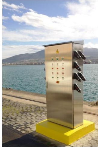
Ilustración 20. Monaguillo de conexión a buques en el Muelle Espigón, en el Puerto de Melilla. Fuente: puertos.es
