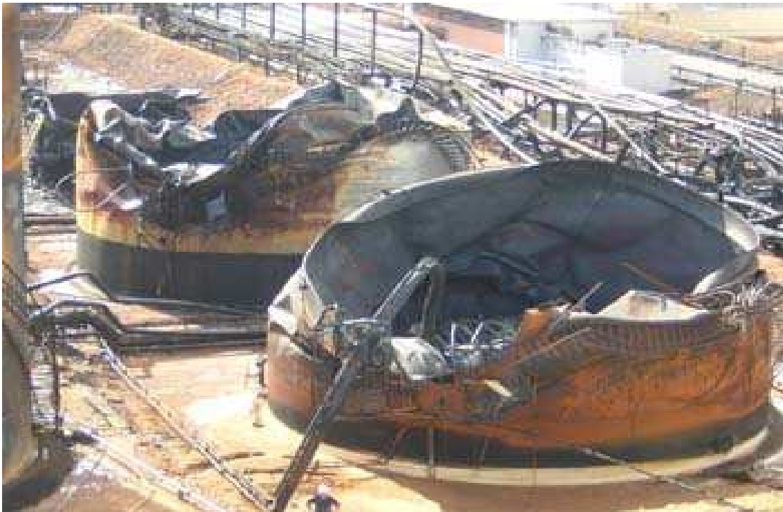
Figura 8.12. Consecuencias del incendio en la refinería de Luanda
