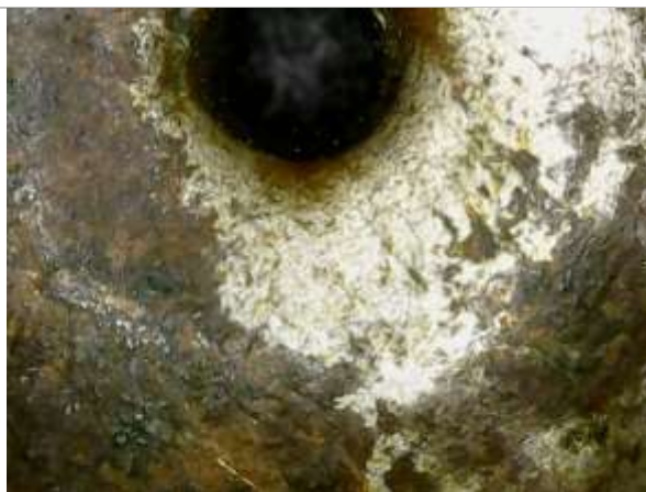
Figura 0.89. Erosión de las tachuelas.
