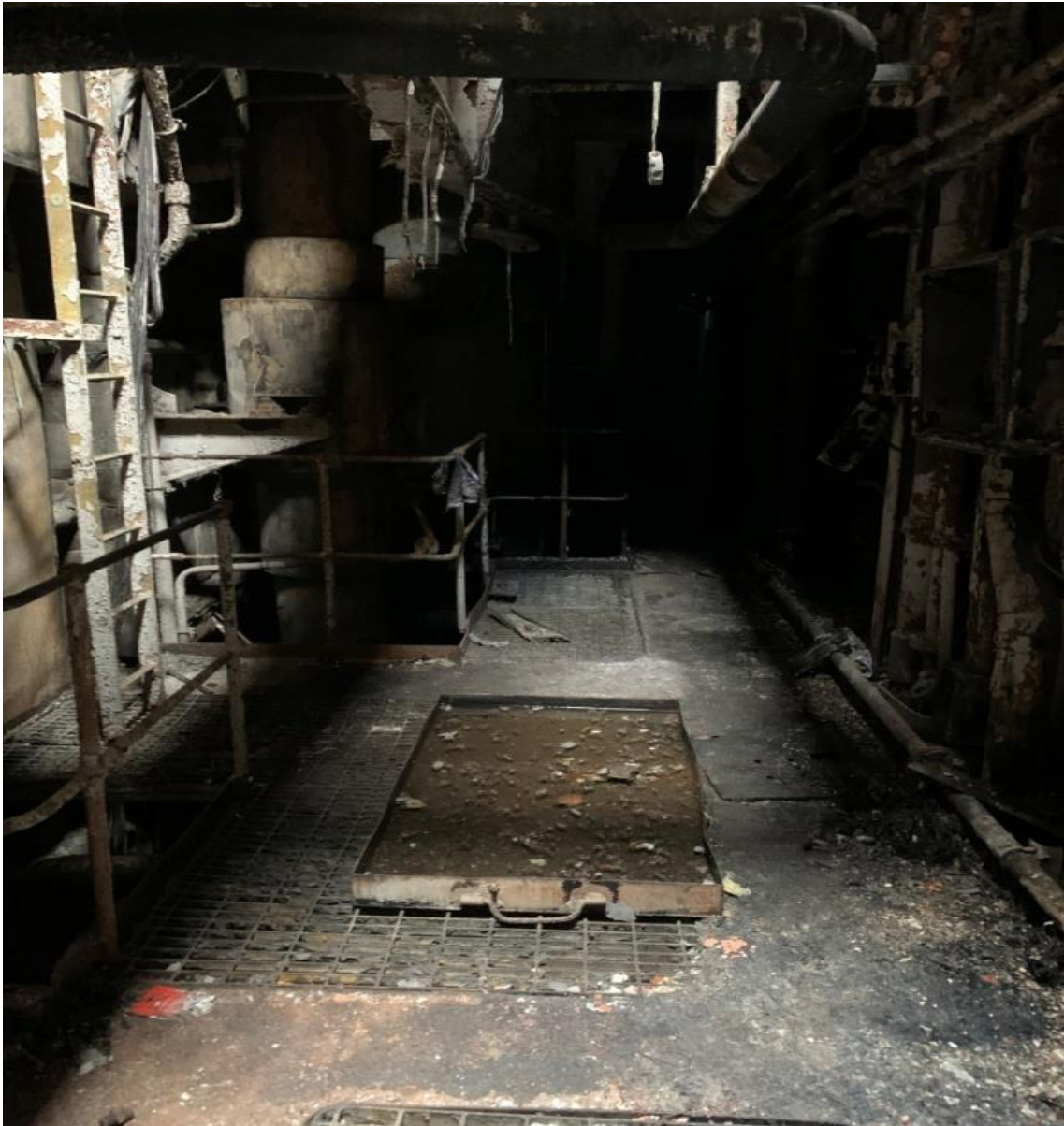
Ilustración 13: Local técnico de popa después del incendio Elaboración propia
