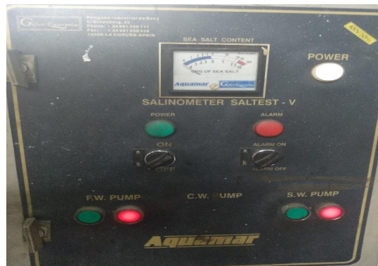
Figura 22. Cuadro eléctrico. Elaboración propia.
