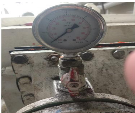
Figura 24. manómetro de entrada al condensador. Fuente propia.
