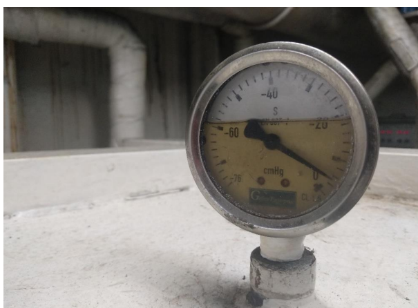
Figura 25. Vacuometro del generador de agua dulce. Fuente propia.
