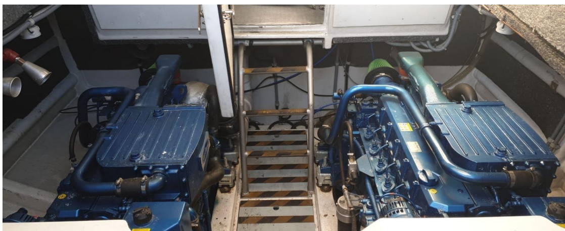
Imagen 19:Sala de máquinas del Punta del Viento. Fuente Propia
