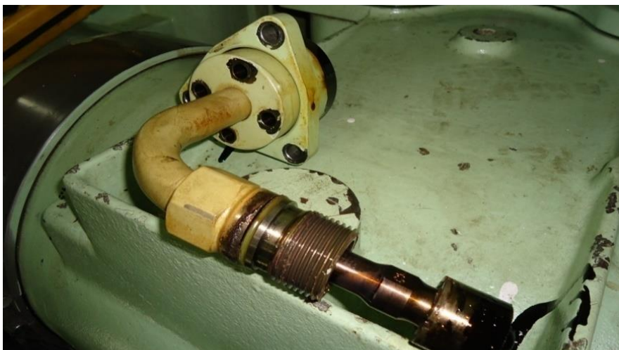
Ilustración 38: Tubería de inyección
