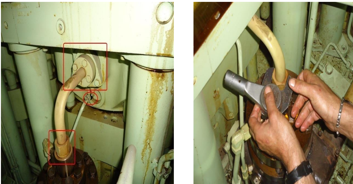
Ilustración 37. Tubería de inyección
