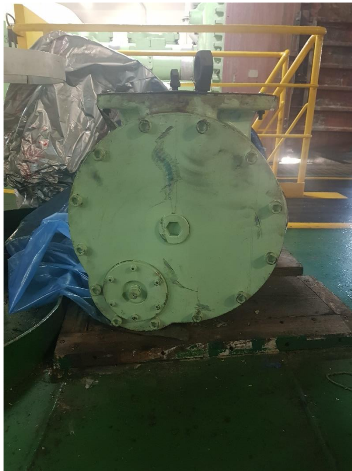
Ilustración 56. Bomba acoplada de respeto
