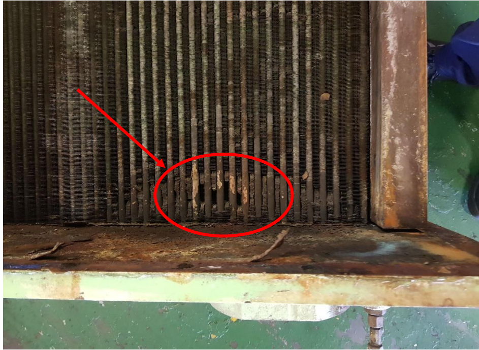
Ilustración 69. Picadura en el enfriador del aire de carga
