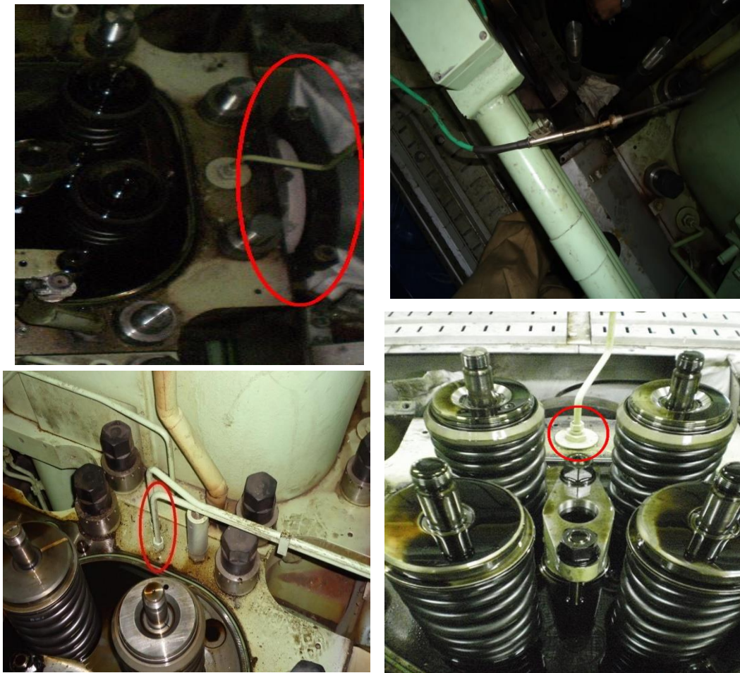
Ilustración 39. Tubos de lubricación
