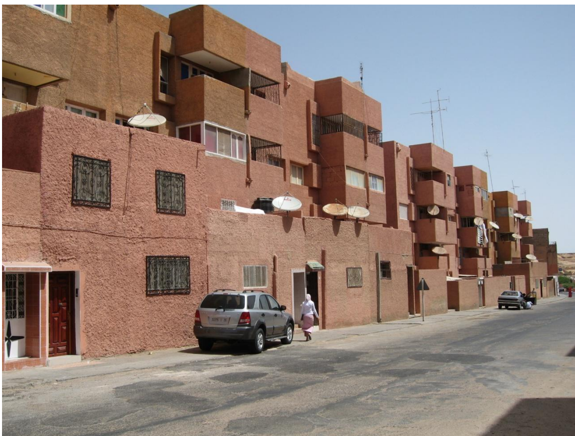
FIGURA 202. Aaiun. Estado actual de las viviendas, con añadidos que desvirtúan el conjunto.
