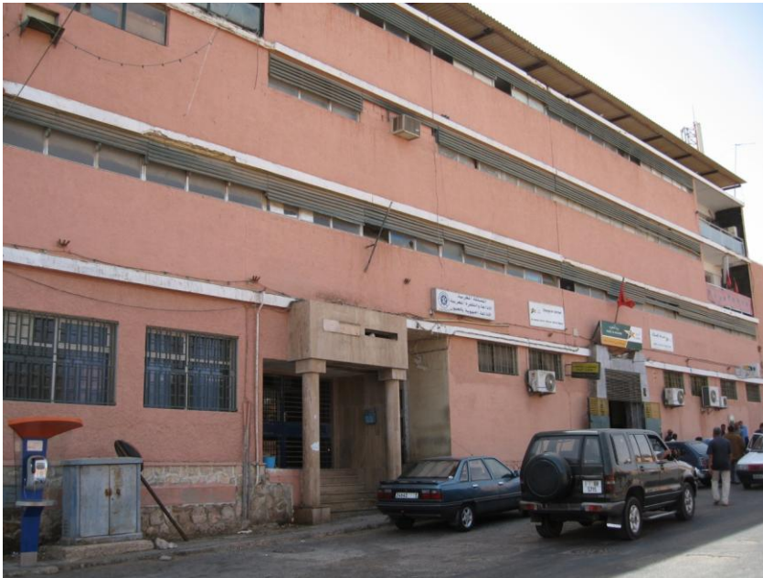
FIGURA 149 . Estado actual de uno de los edificios multiuso. Aaiun, 2006.
