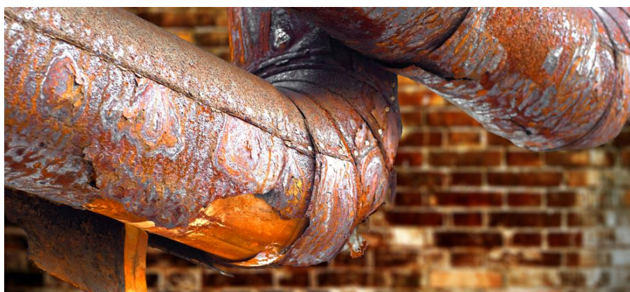
Figura 1. Imagen de los efectos de la corrosión en tuberías. Reproducido de [8].
