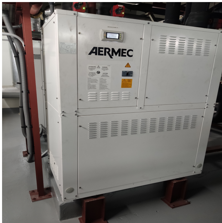
Figura 4.2: Bomba de calor Booster. Fuente: Hotel Abama
