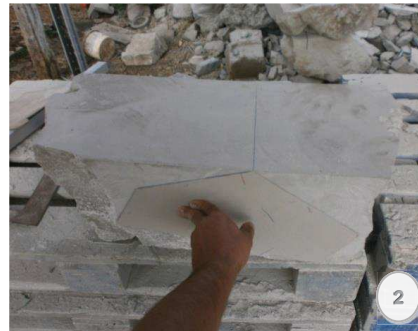
Figura 2.- Labrado del primer, segundo y tercer paramento. Traza del cuarto y quinto paramento.
