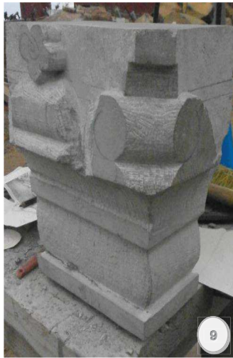
Figura 9.- Vista del desbaste de las molduras del ábaco y juegos de volutas.
