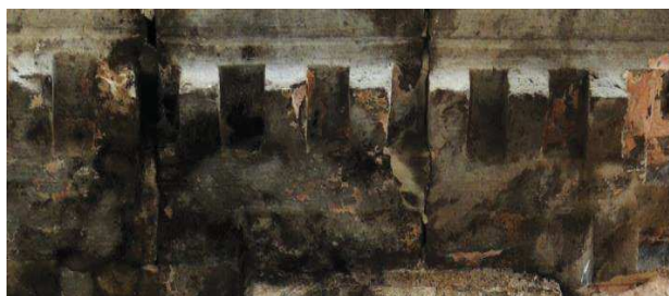
Figura 11.- Detalle de la cornisa.
