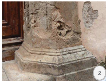
Figura 2.- Basamento derecho de la portada Norte de la iglesia de La Concepción.
