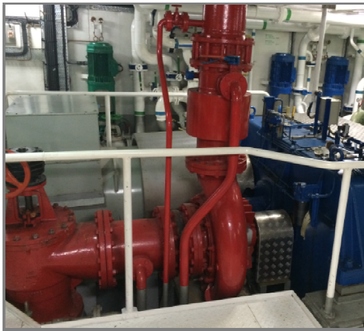
Imagen n°30: Bomba del sistema de lucha contra incendios.
