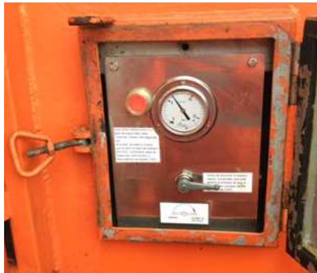
Imagen nº34: Manómetro y palancas de activación de sistema de CO 2 .
