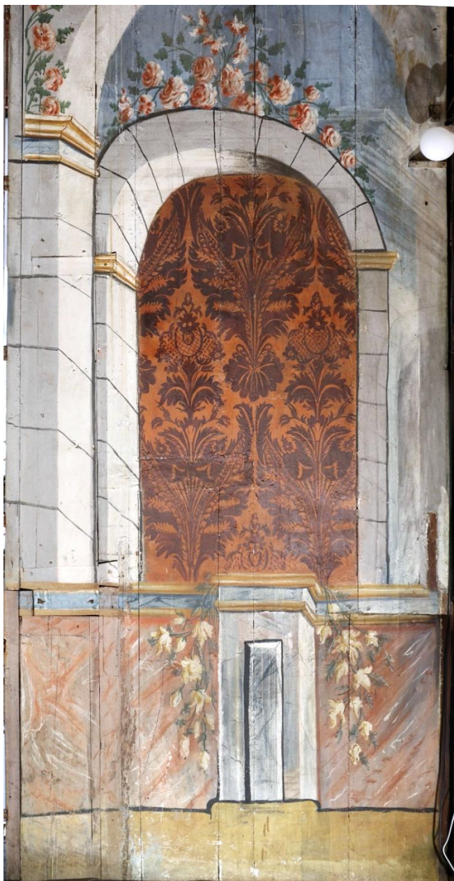
Fig.33. Imagen general panel izquierdo antes de la intervención.
