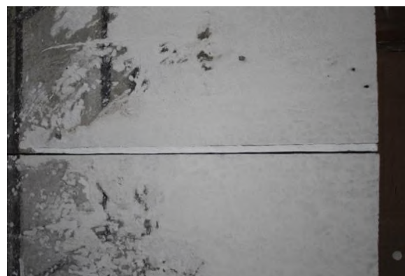
Fig.114. Detalle de la pérdida de la capa de preparación de la puerta de la Epístola, antes de la reintegración volumétrica.
