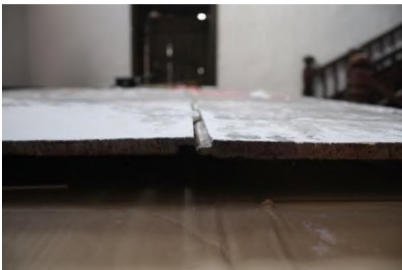
Fig.111. Detalle de la pérdida de la capa de preparación de la puerta del Evangelio, antes de la reintegración volumétrica.
