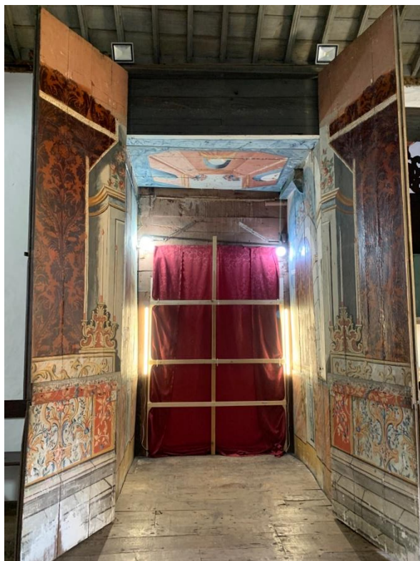
Fig.156. Imagen general de la Hornacina desde el interior de el retablo antes de la intervención.
