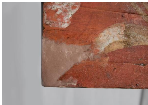
Fig.108. Pérdida de soporte en la puerta de la Epístola, después de la reintegración volumétrica.
