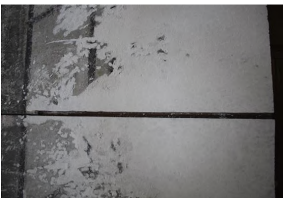
Fig.113. Detalle de la pérdida de la capa de preparación de la puerta de la Epístola, antes de la reintegración volumétrica.
