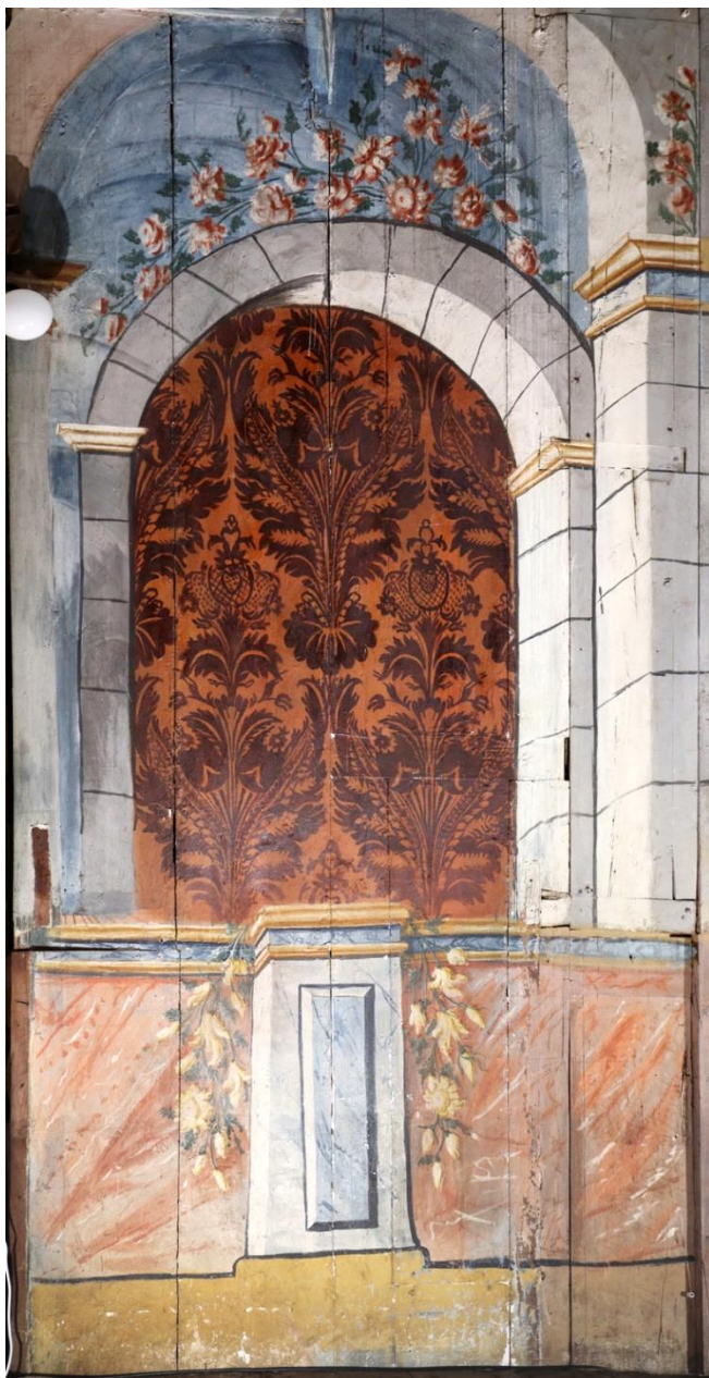
Fig.31. Imagen general panel derecho antes de la intervención.
