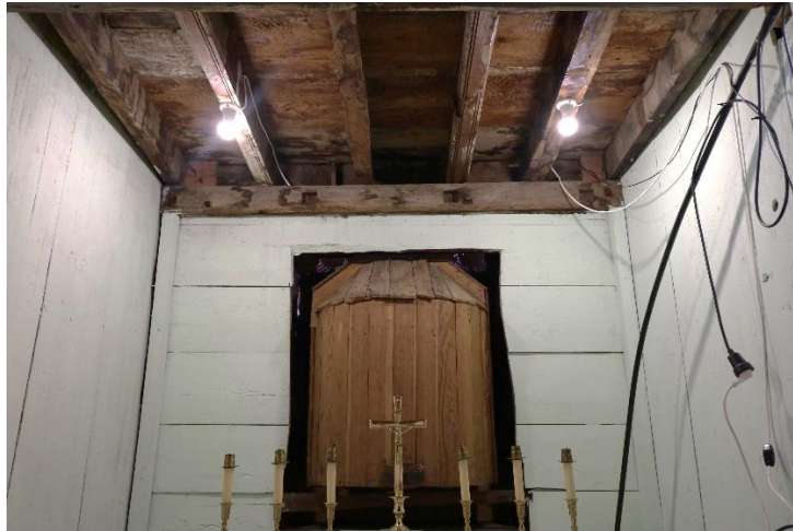
Fig.23. Habitáculo o acceso al manifestador desde la sacristía. Vista trasera del suelo de la Hornacina. Vigas apoyadas sobre la viga de apoyo
