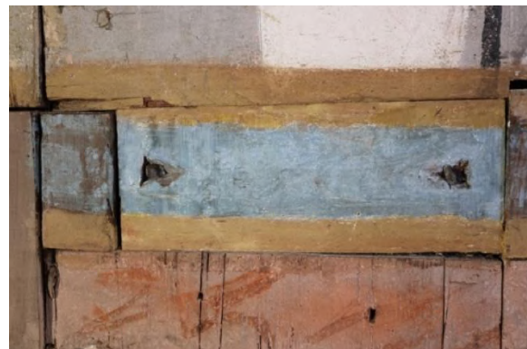
Fig.145. Detalle de Manchas de humedad causadas por el agua en el panel interior, Epístola, después de la reintegración cromática con goma arábica y pigmentos.
