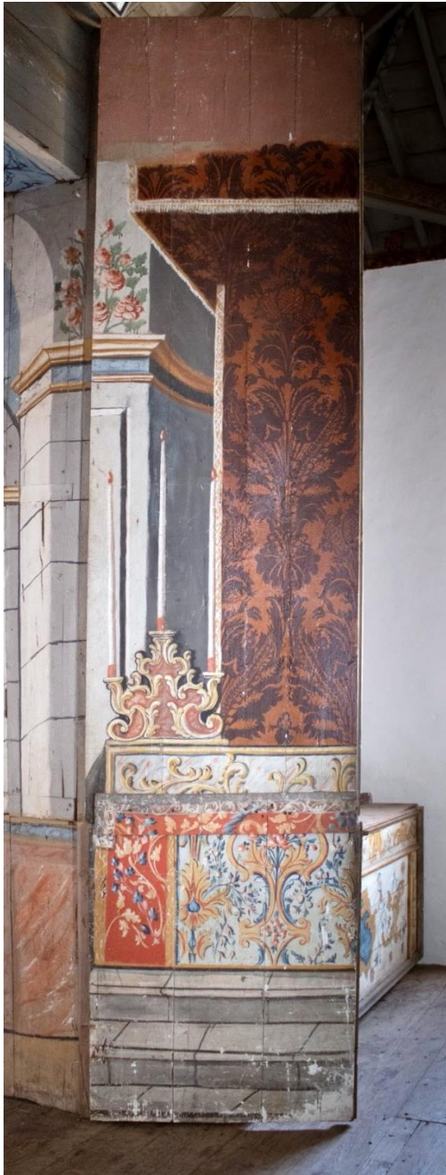
Fig.29. Imagen general puerta derecha antes de la intervención.
