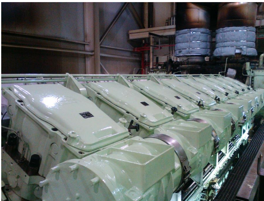
Ilustración 40. Man 48/60, línea B vista de popa a proa desde el piso de culatas
