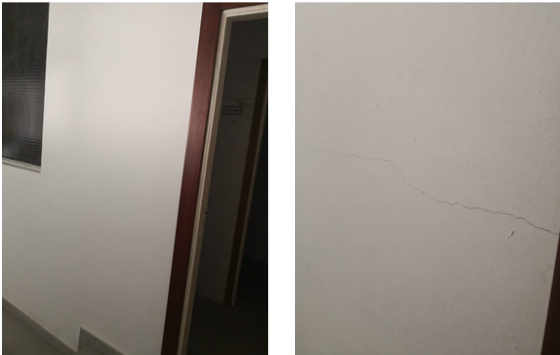
Imagen 10. Grieta en partición.
