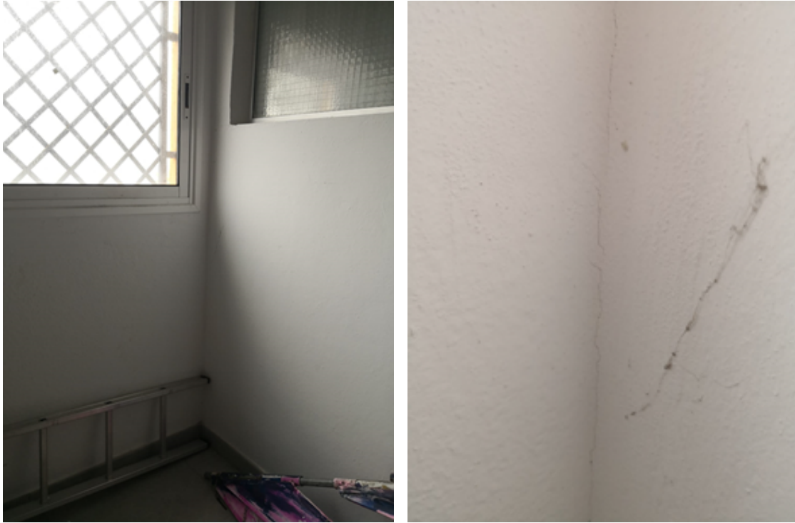
Imagen 7. Fisura vertical en esquina.
