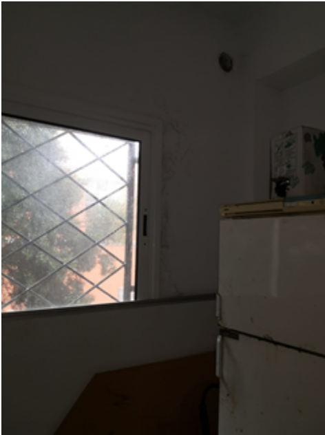
Imagen 5. Humedad por filtración en la cara interior del muro portante.
