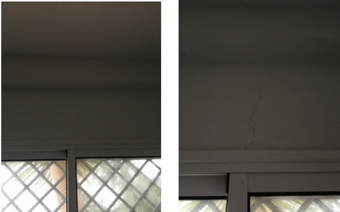
Imagen 8. Fisura vertical en cara interior de muro portante.
