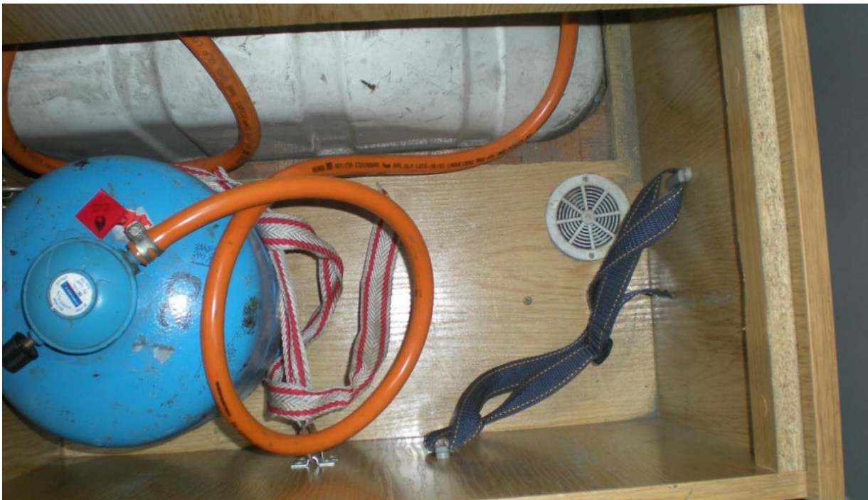
Figura 50. Caso 3 instalación de gas. Fuente: www.furgovw.org
