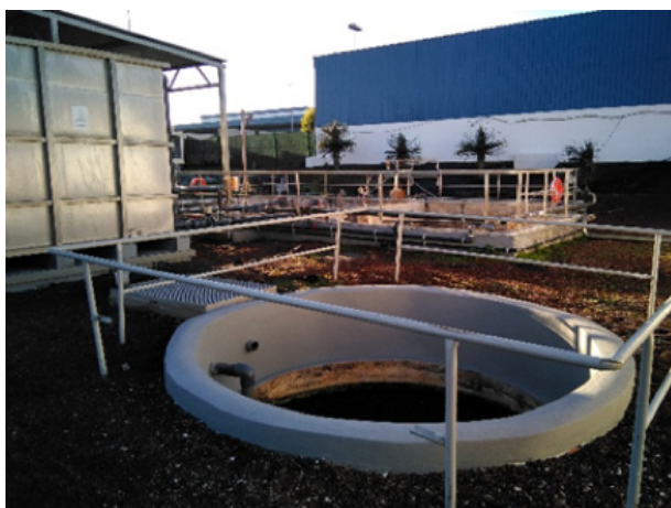
Figura 4.2. Instalaciones interiores de la depuradora de Guamasa
