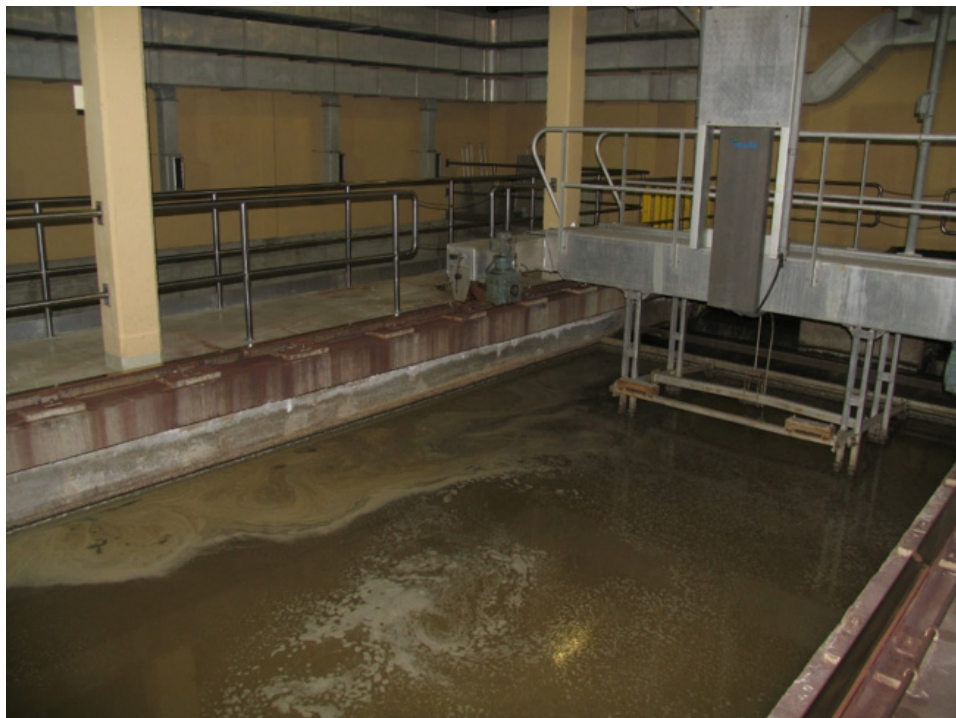
Figura 1.6. Interior de una depuradora de aguas residuales en Tenerife
