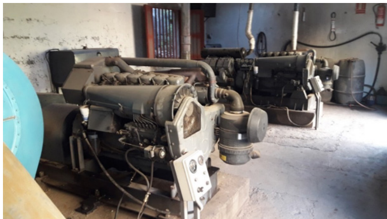
Figura 3.5. Sala de máquinas de la galería de Arico, Tenerife
