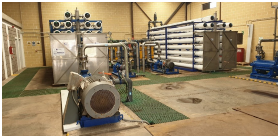
Figura 5.3. Instalaciones interiores de la IDAM Las Galletas, constituidas por dos líneas
