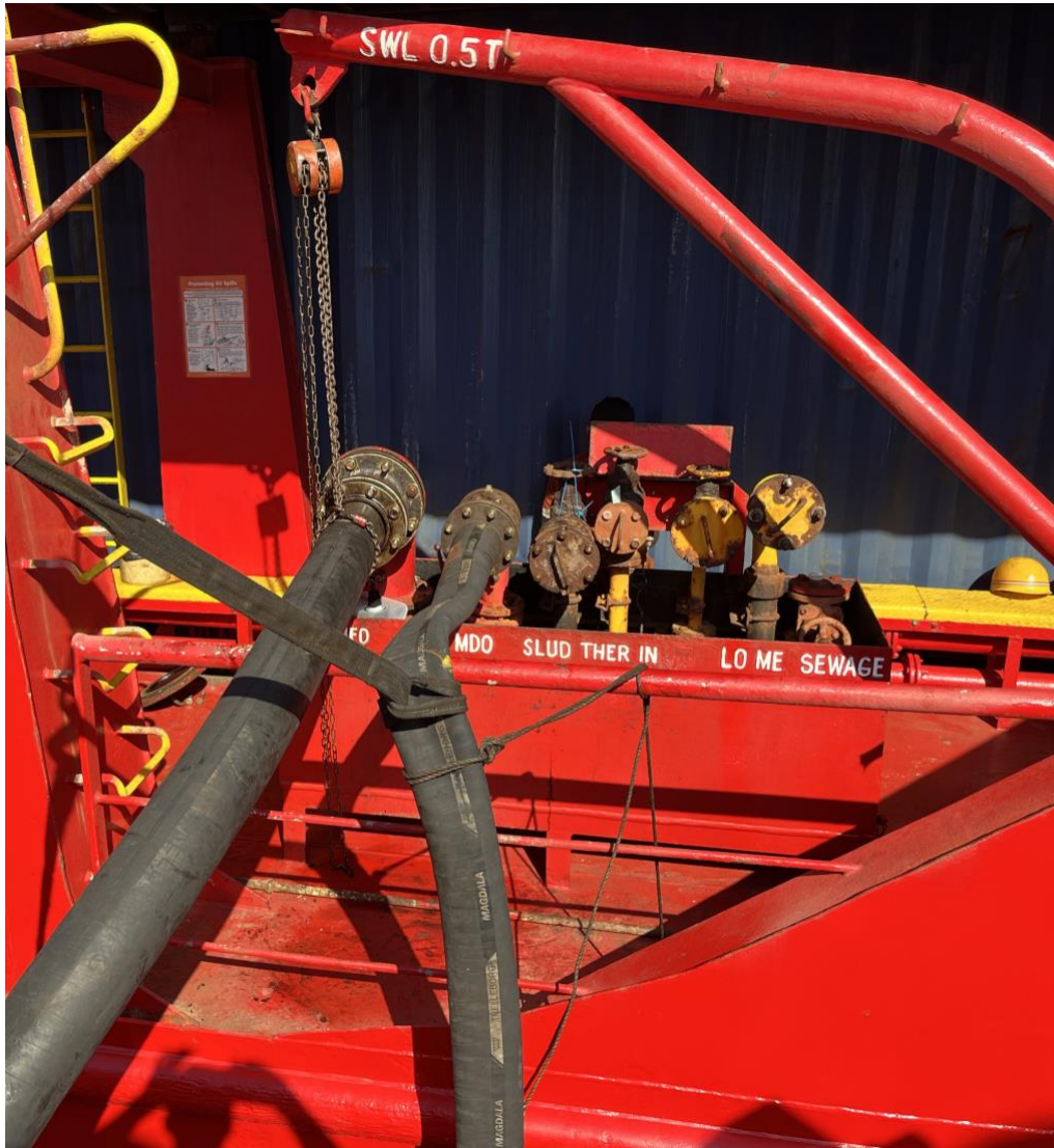
ILUSTRACIÓN 5. IMAGEN ILUSTRATIVA MANGUERAS DE FUEL Y GASOIL CONECTADAS. ELABORACIÓN PROPIA.
