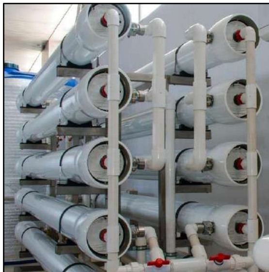
Figura 9. Bastidor para Osmosis Inversa.
