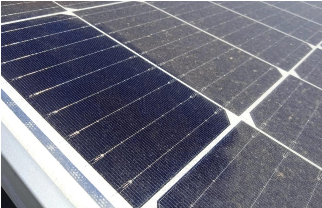
Figura 52: Estado de la instalación real dispuesta, vista cercana. Elaboración propia.
