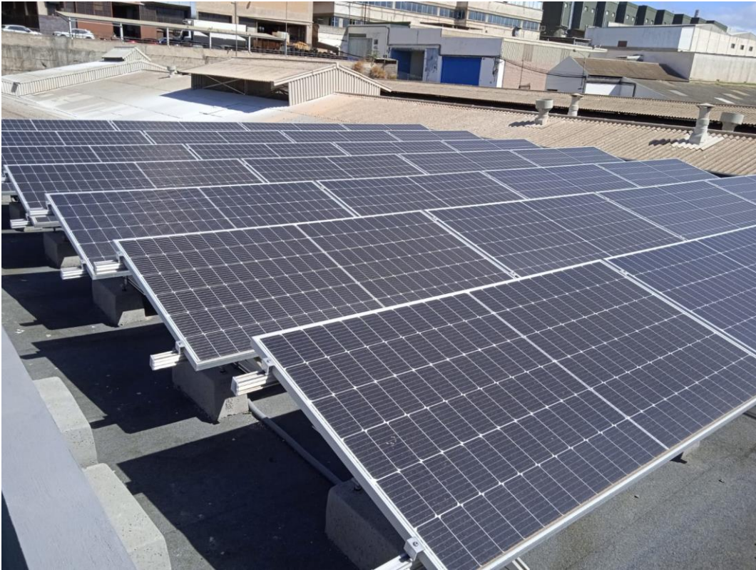
Figura 51: Estado de la instalación real dispuesta, vista general. Elaboración propia.
