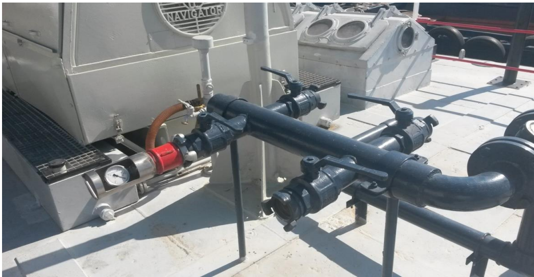
Ilustración 4: Conjunto de válvulas de cubierta
