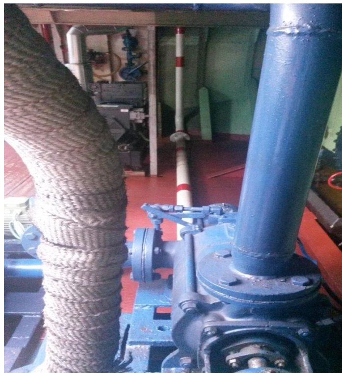
Ilustración 15: Tren de descarga de la bomba Nº 1
