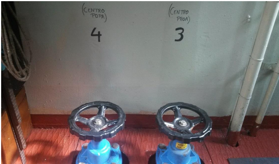
Ilustración 8: Válvulas de compuerta de los tanques 3 y 4
