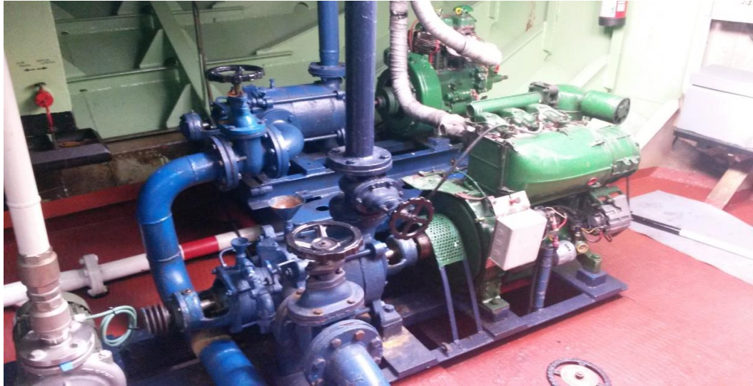
Ilustración 2: Conjunto de bombas del aljibe con sus respectivos motores diésel
