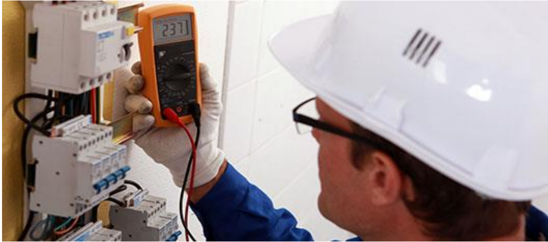
Ilustración 34: Comprobación de parámetros eléctricos en un transformador (Codensa S.A., 2016)
