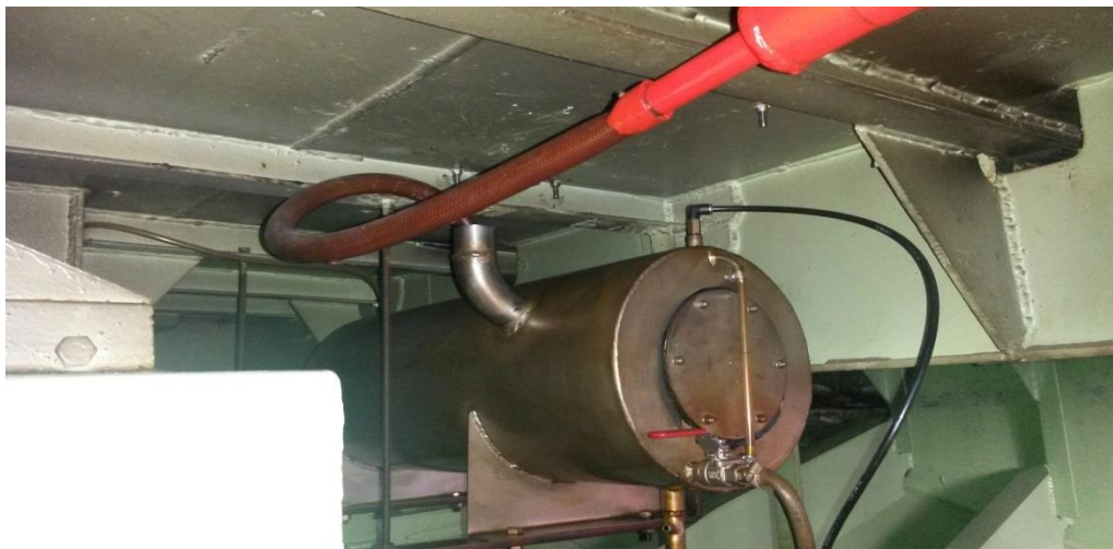
Ilustración 11: Tanque N° 2 de combustible
