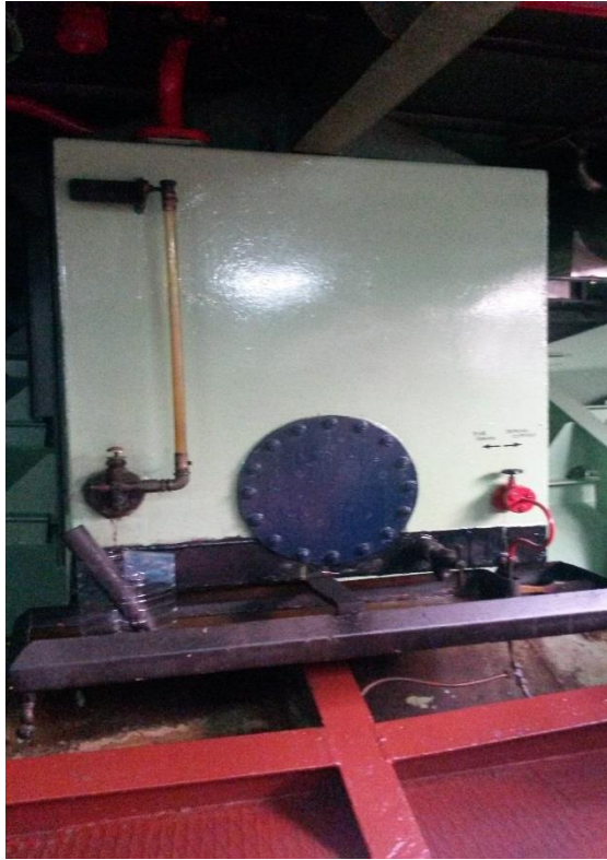
Ilustración 12: Tanque N° 1 de combustible
