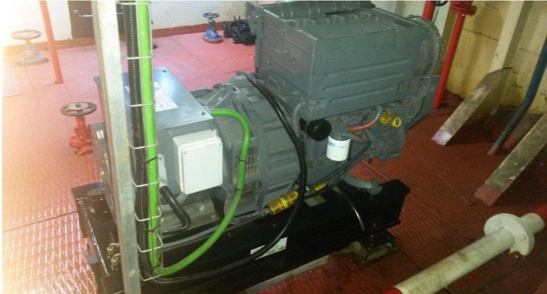
Ilustración 16: Generador de emergencia
